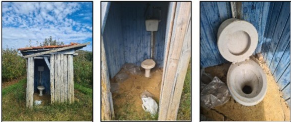
Figura 7 – Instalação sanitária desativada dentro do pomar de maçã.
