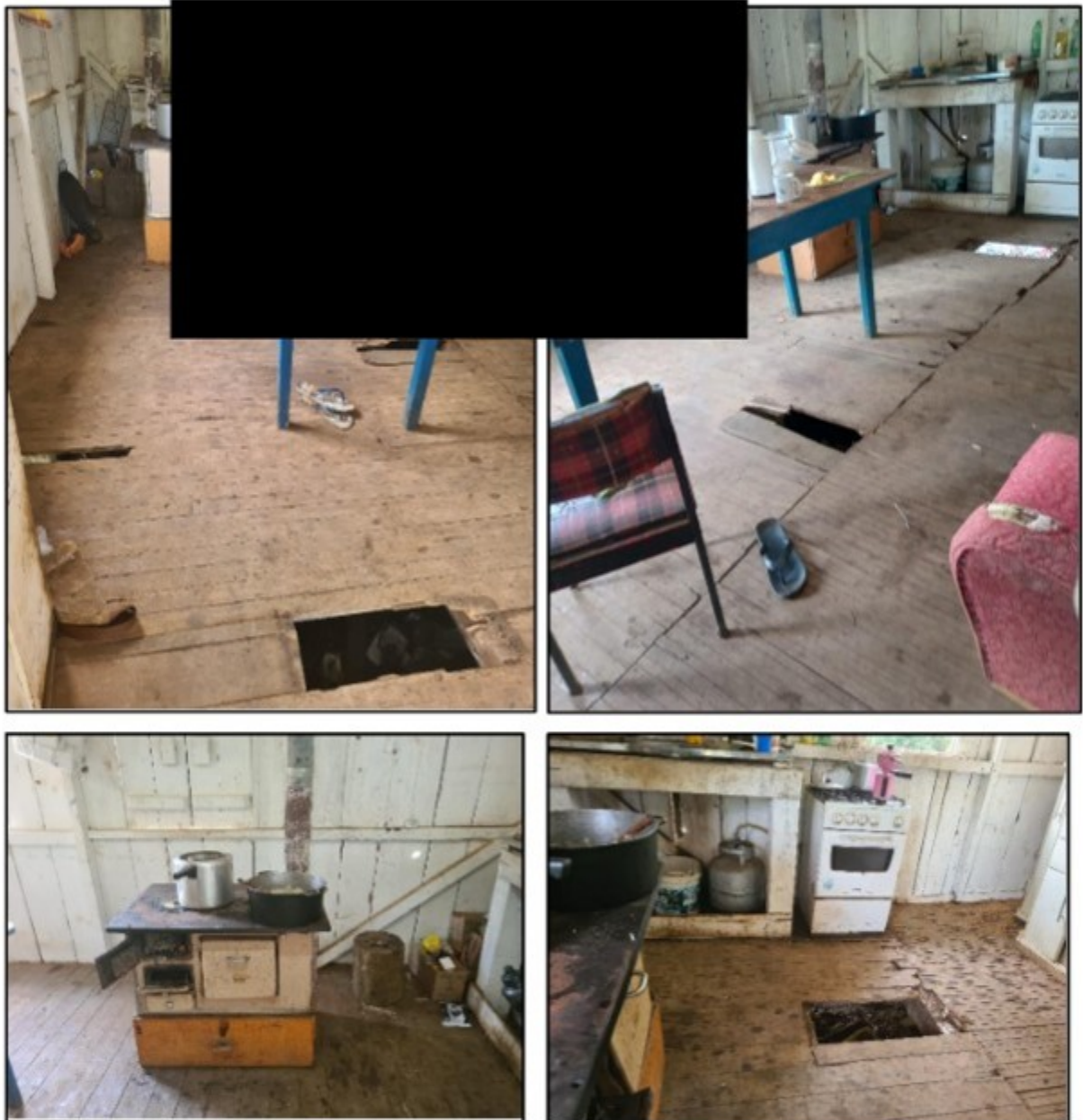
Figura 10 – Alojamento dos trabalhadores, piso de madeira com vários buracos em função do apodrecimento das tábuas, perigando vir a ceder por completo.
