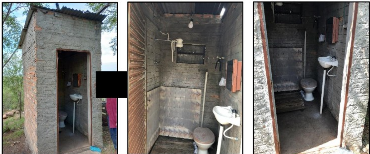
Figura 5 – Instalação sanitária existente sem caixa de descarga.
