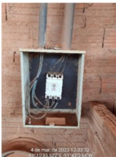
Foto 5: quadro elétrico sem tampa e com disjuntor com partes vivas expostas, na oficina existente na fazenda inspecionada.
