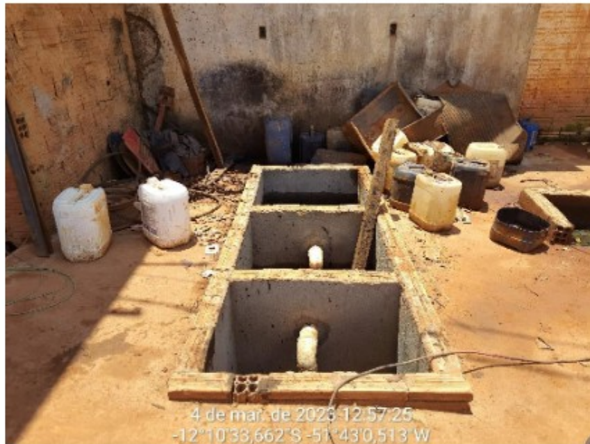
Foto 7: aberturas no piso na área adjacente da oficina existente na fazenda inspecionada.
