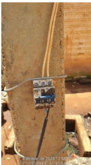
Foto 3: disjuntor com partes vivas expostas nas adjacências da oficina existente na fazenda inspecionada.
