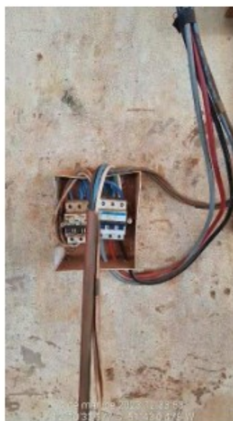
Foto 6: quadro elétrico sem tampa e com disjuntor com partes vivas expostas, na oficina existente na fazenda inspecionada.
