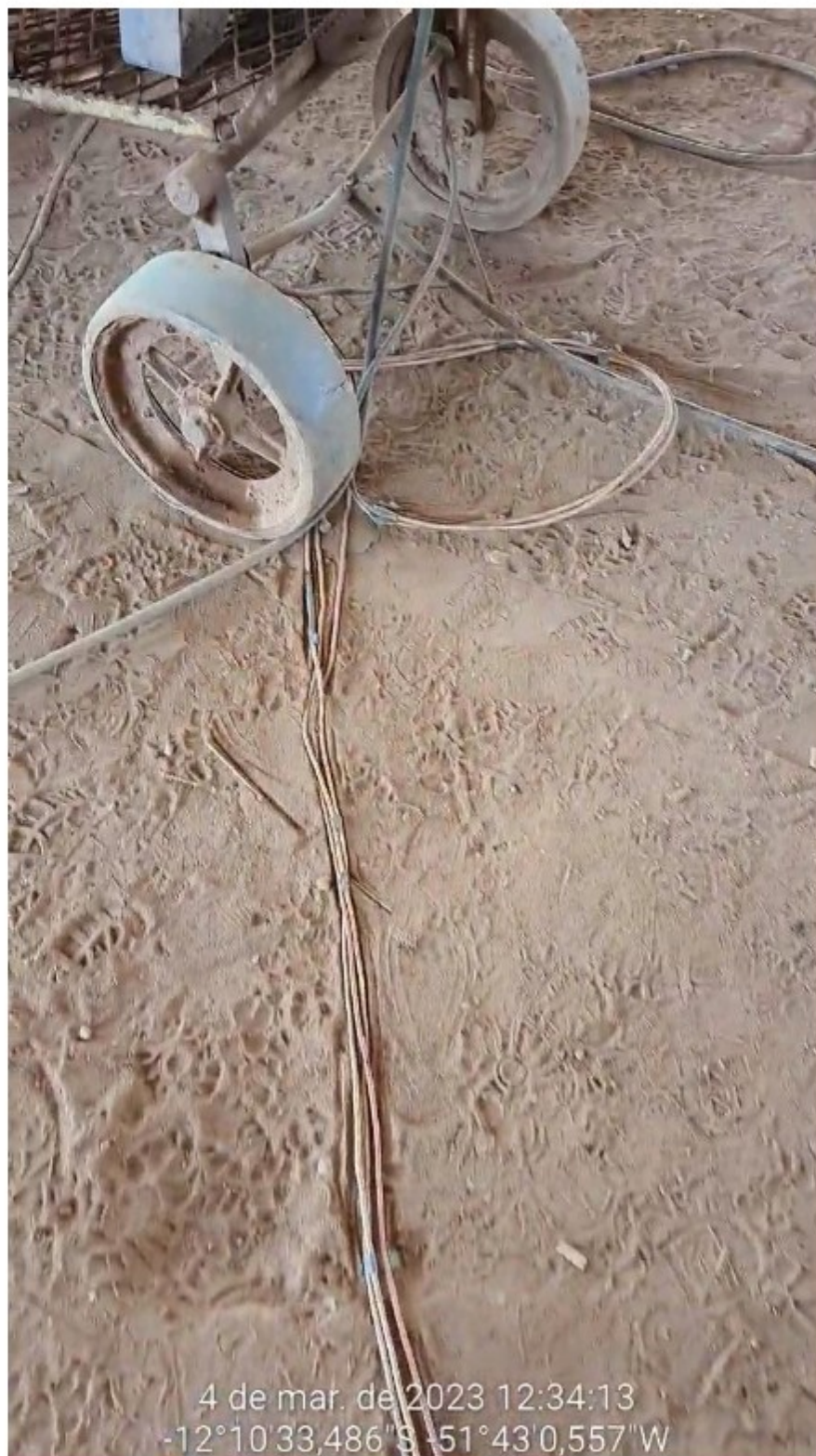
Foto 4: fiação com isolamento simples no chão da oficina existente na fazenda inspecionada, por onde circulavam trabalhadores.
