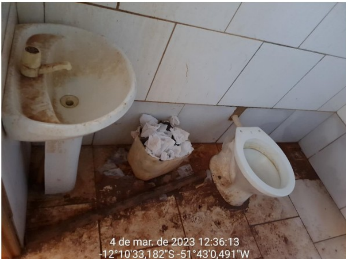
Foto 10: instalações sanitárias da oficina existente na fazenda fiscalizada mantidas em condições inadequadas de conservação, limpeza e higiene.
