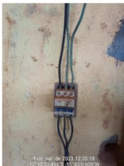
Foto 2: disjuntor com partes vivas expostas na oficina existente na fazenda inspecionada.
