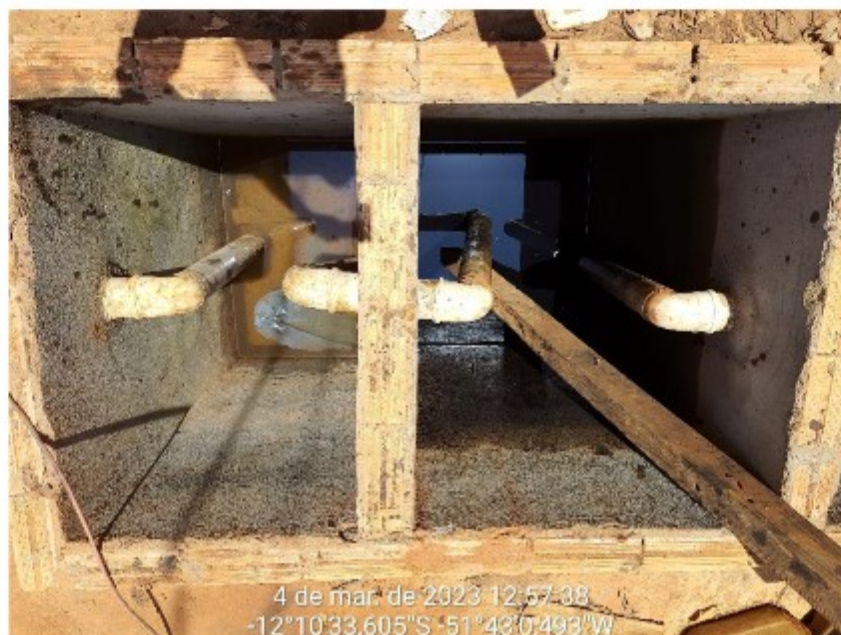
Foto 8: detalhe de abertura no piso na área adjacente da oficina existente na fazenda inspecionada.
