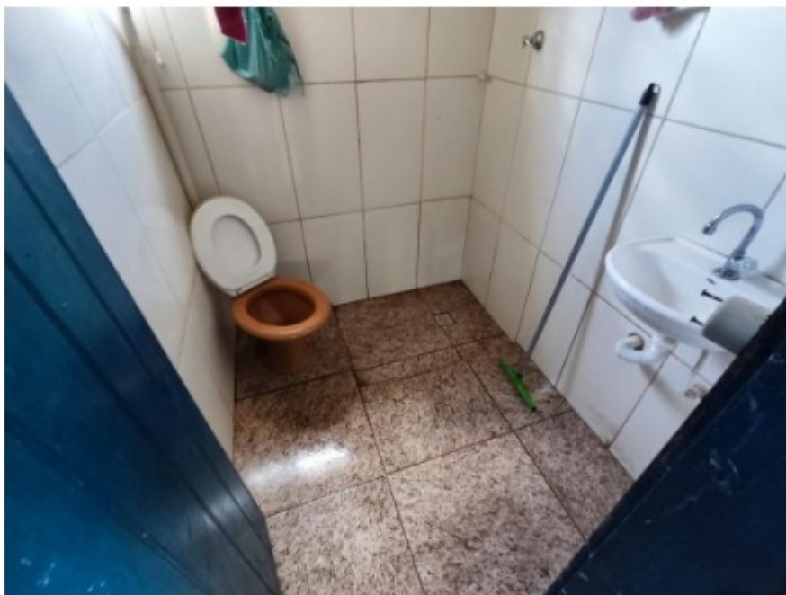
Foto: instalação sanitária
