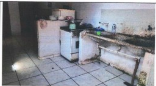
Foto 10 - Ausência de armários para armazenagem dos utensílios de cozinha, que ficam armazenados em cima de um fogão velho.
