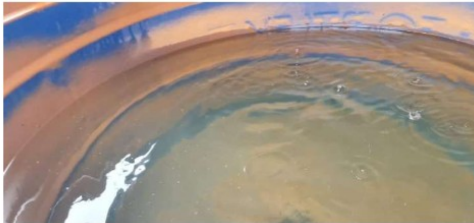
Foto do interior do reservatório de água
