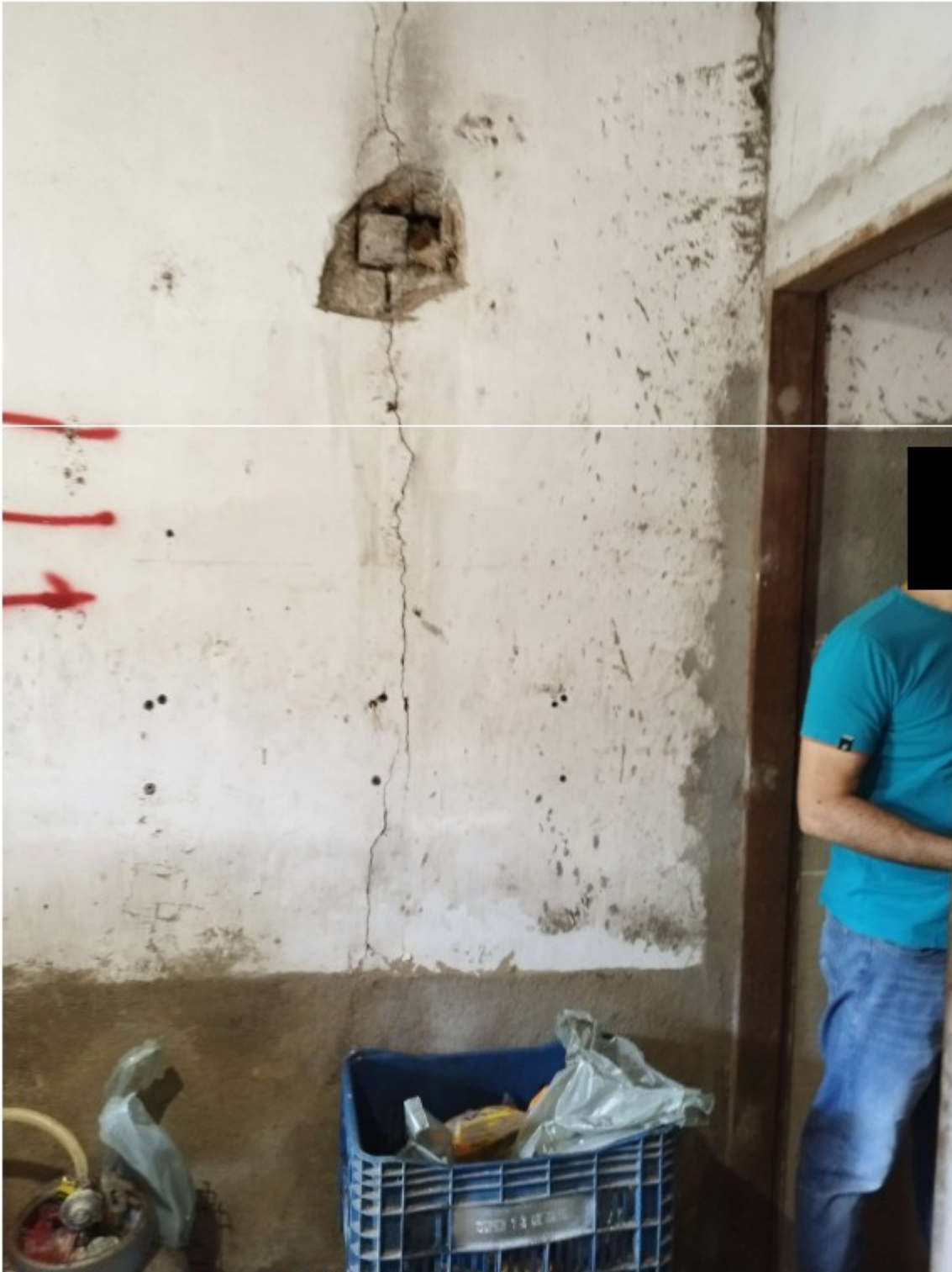
Rachaduras e comprometimentos das paredes.
