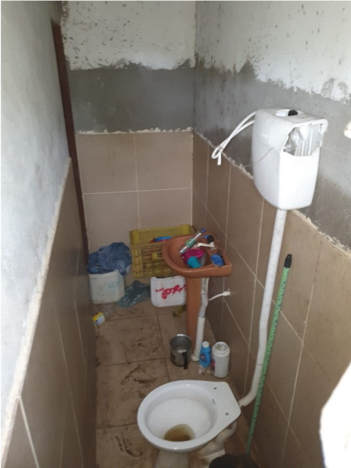
Condições precárias de higiene do banheiro. Descarga danificada e panelas para preparo de alimentos encontradas no chão do banheiro.
