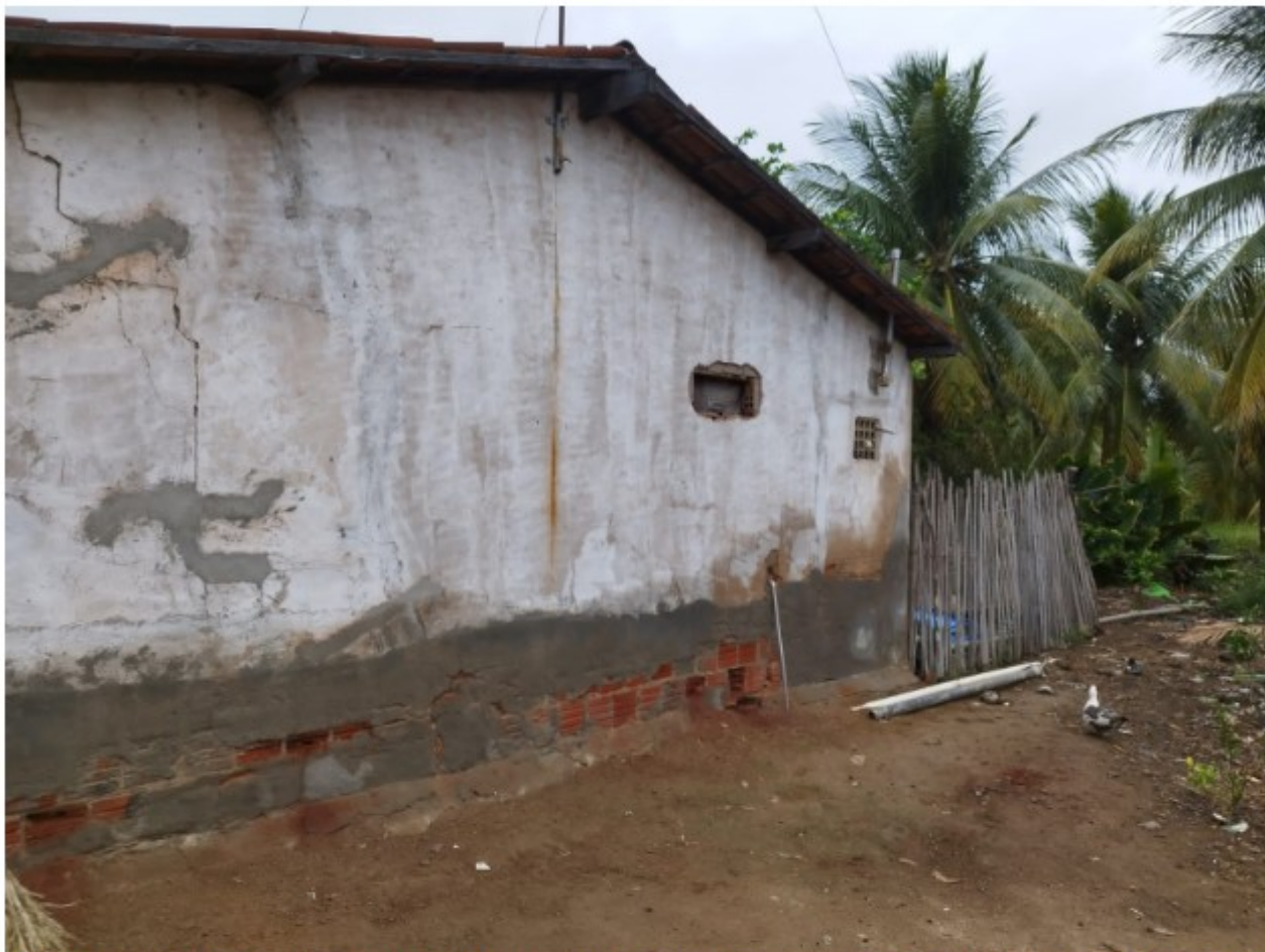
Parede lateral do alojamento, mostrando abertura, sem janela, na parte superior da parede do banheiro, comunicando-se com o meio externo com saco plástico fechando a abertura.
