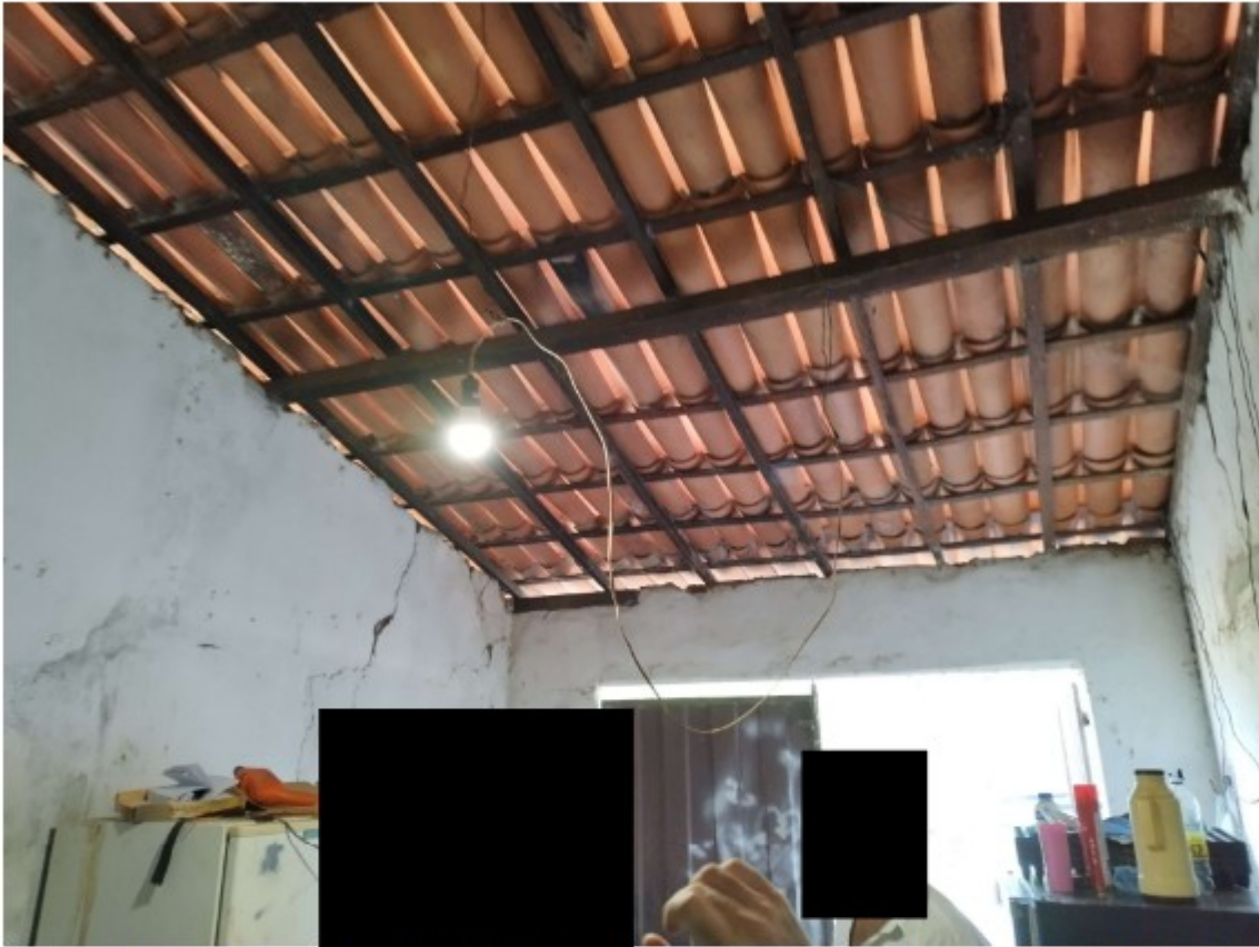
Fotografia demonstrando a existência de rachaduras estruturais, espaços entre o telhado e as paredes e a fiação exposta e pendurada nas ripas do telhado.
