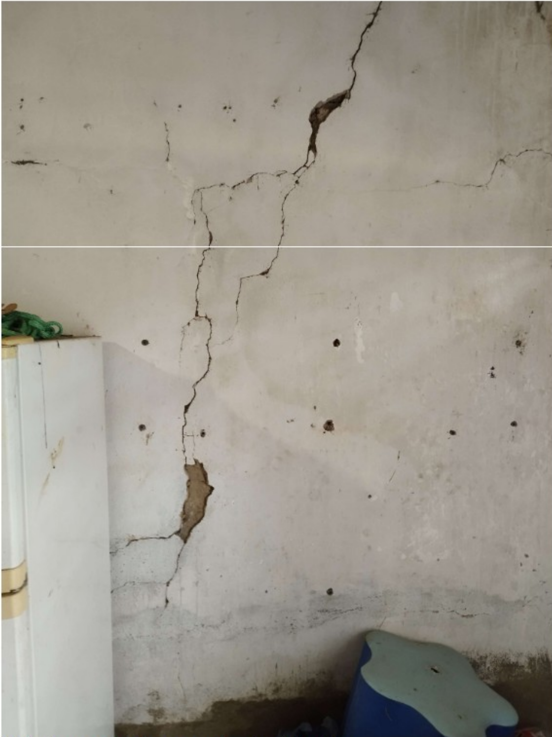
Rachaduras por todas as paredes da edificação.
