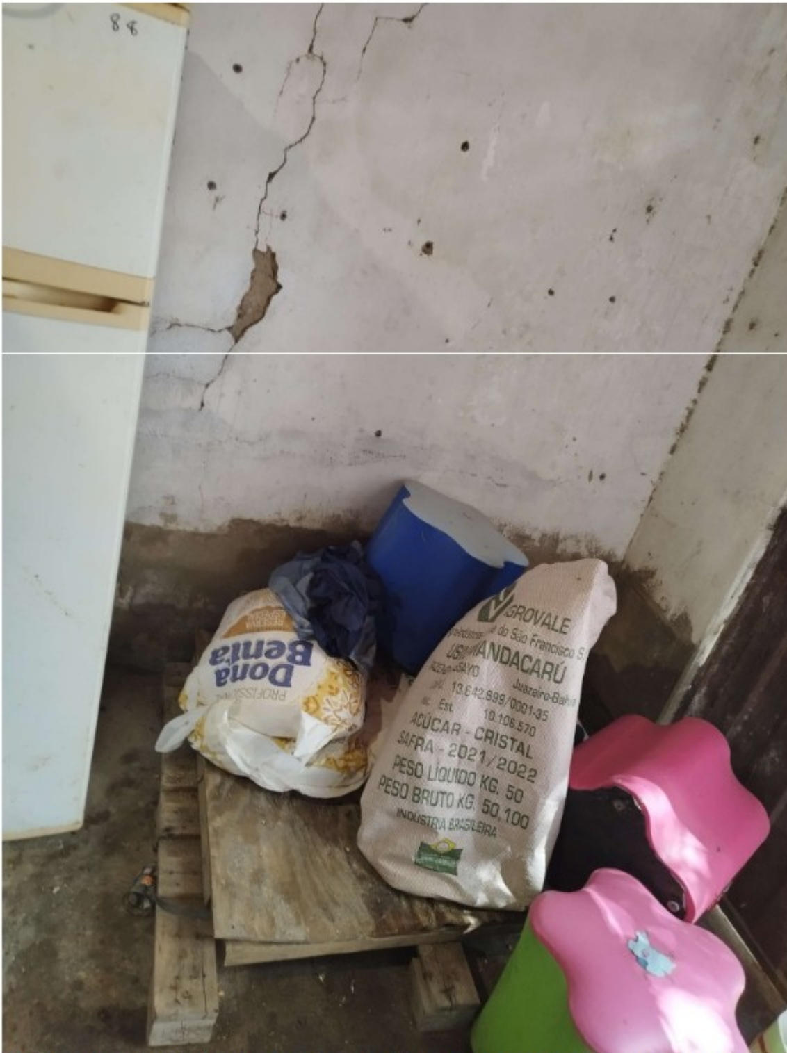
Rações de animais armazenadas no alojamento e rachaduras na parede.
