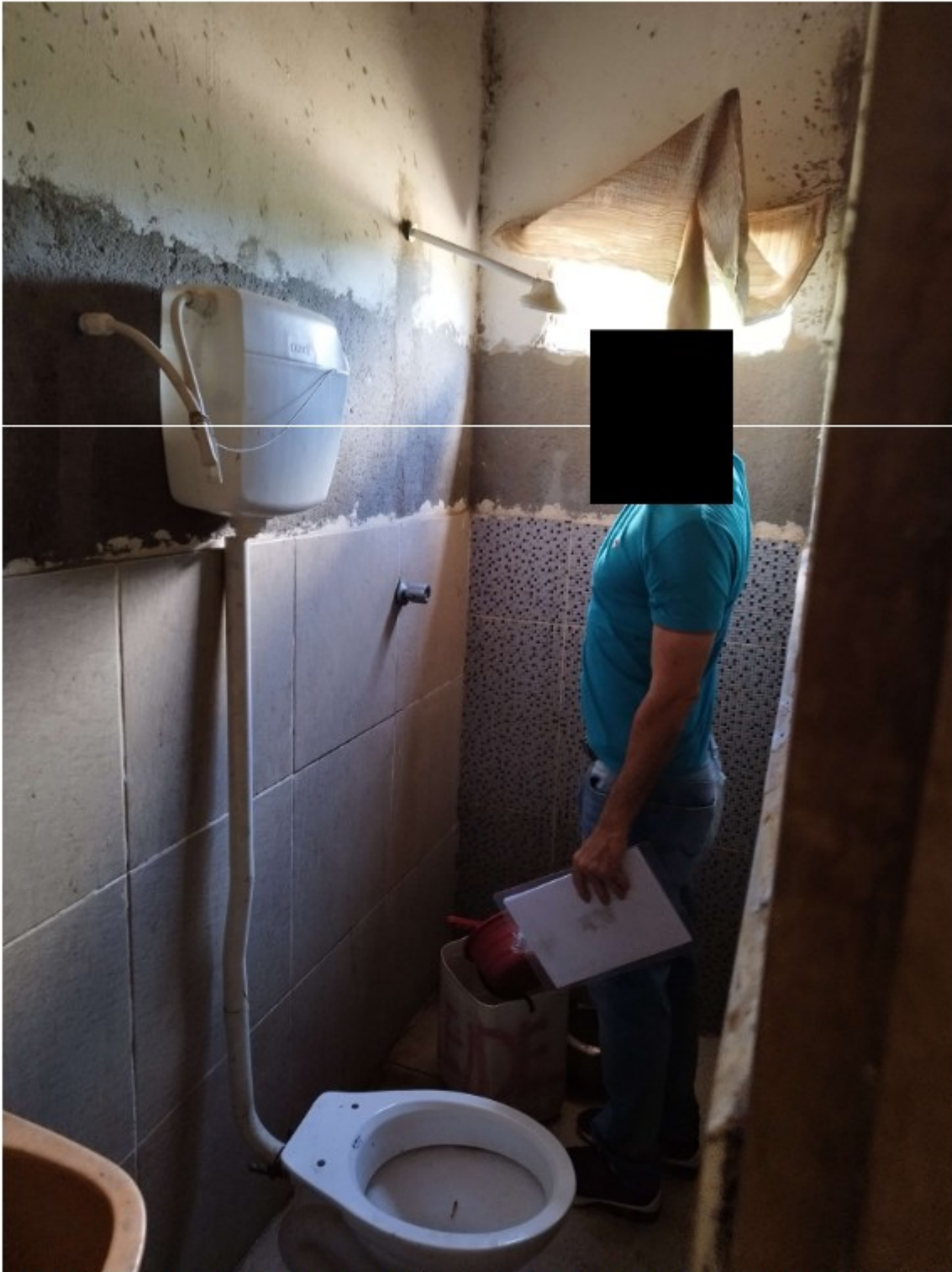
Instalação sanitária contendo pia, bacia sanitária, sem assento nem tampa, e abertura na parede sem janela coberta por saco plástico.
