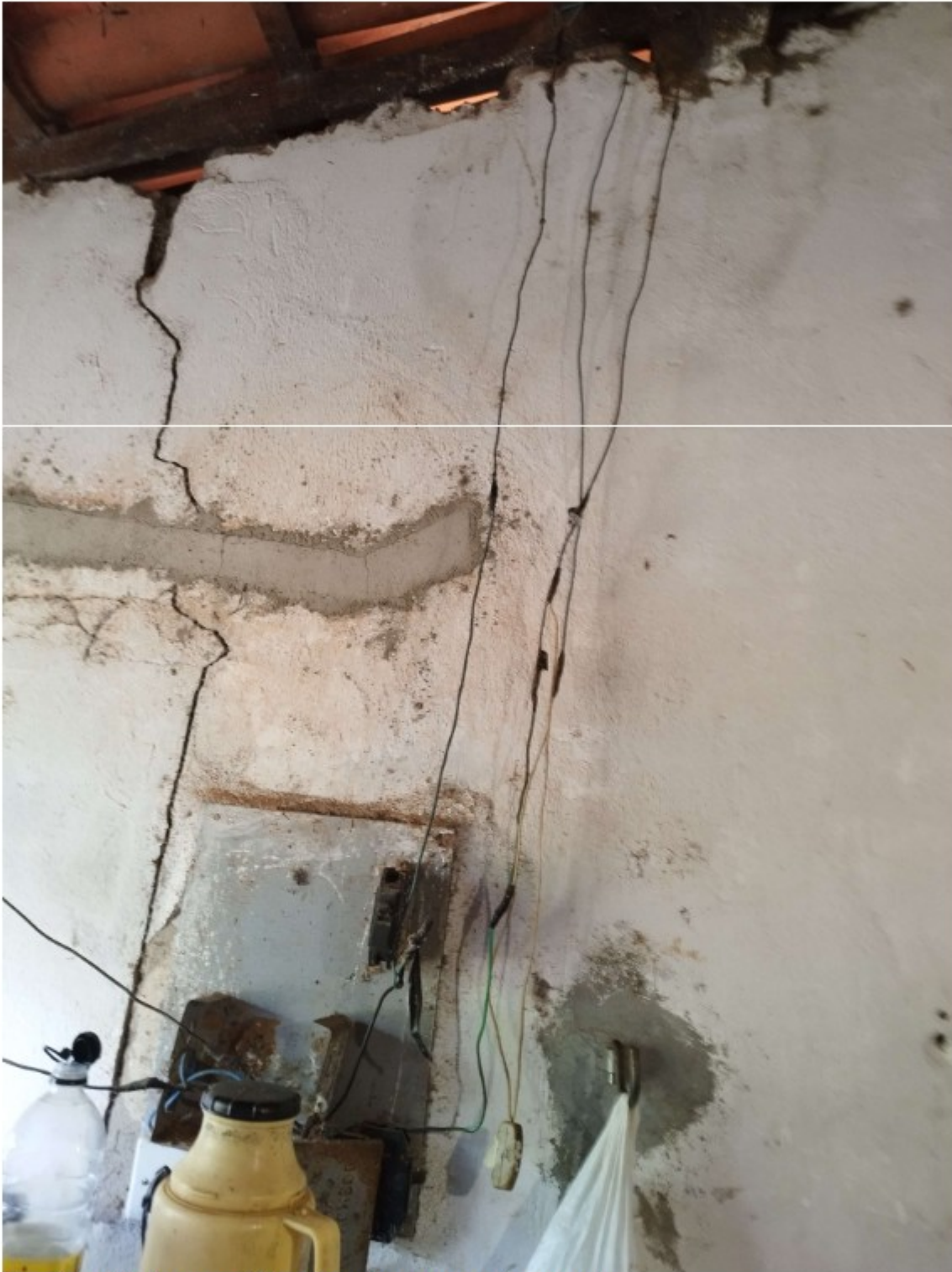
Fiação elétrica precária e rachaduras pela parede.
