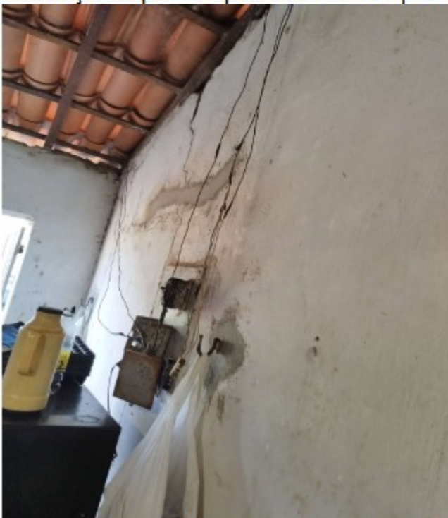
Fiação exposta, sem canaletas, com a existência de uma única tomada sobrecarregada com a ligação de alguns aparelhos elétricos como geladeira e carregador de celular.
