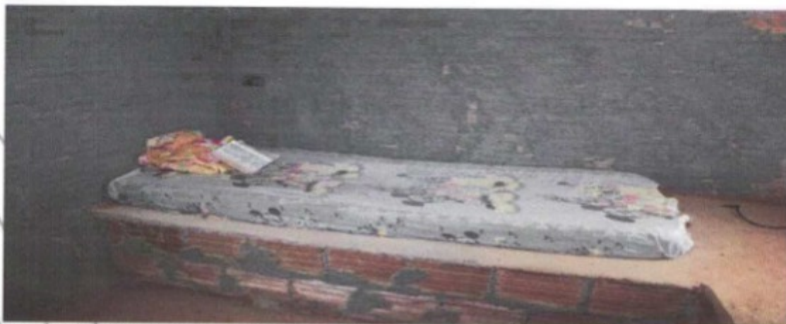
Quartos com seis metros quadrados, duas camas sobre base de cimento no momento da inspeção física.
