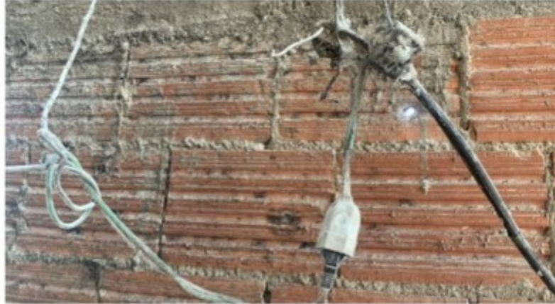
Instalação elétrica precária com emendas
