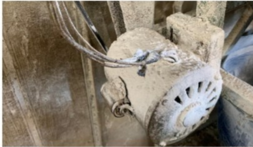
Instalação elétrica com emendas precárias e sujeira
