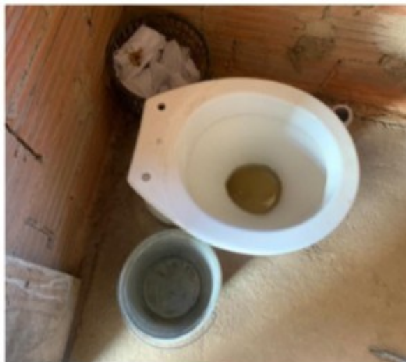
“Banheiro” existente, sem descarga instalada e com uso de balde
