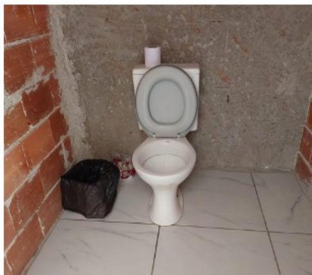
Banheiro apenas com vaso sanitário
