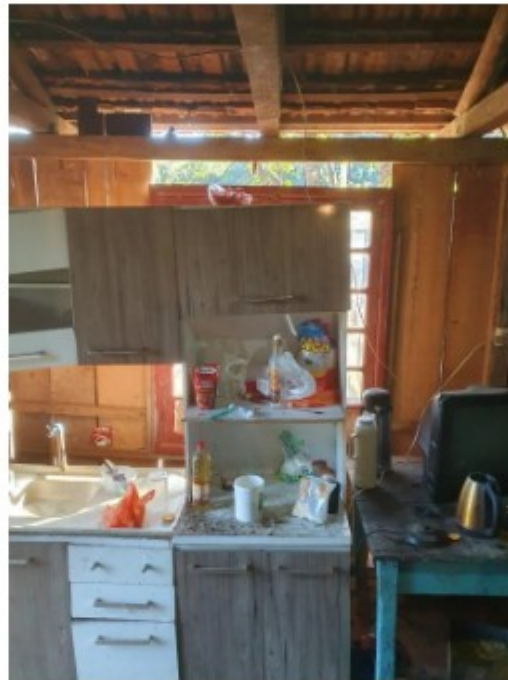
(condições precárias do armário da cozinha)
