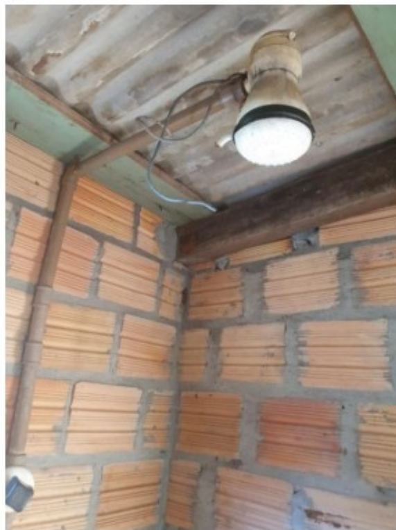
(chuveiro sem ligação elétrica)
