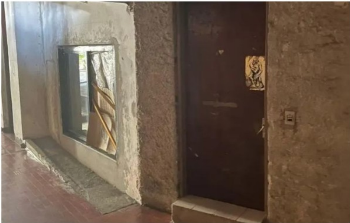
Entrada do dormitório da empregada resgatada. Observar que a janela destinada ao quarto estava com travas e parcialmente coberta com compensado e plásticos, dificultando a sua abertura e comprometendo a ventilação do dormitório
