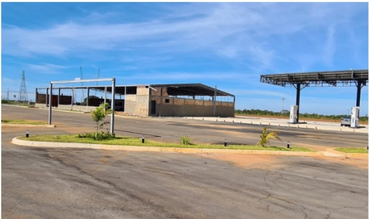
Foto 1. Vista do prédio em construção que abrigará o restaurante. Registro efetuado em 09/05/2023.
