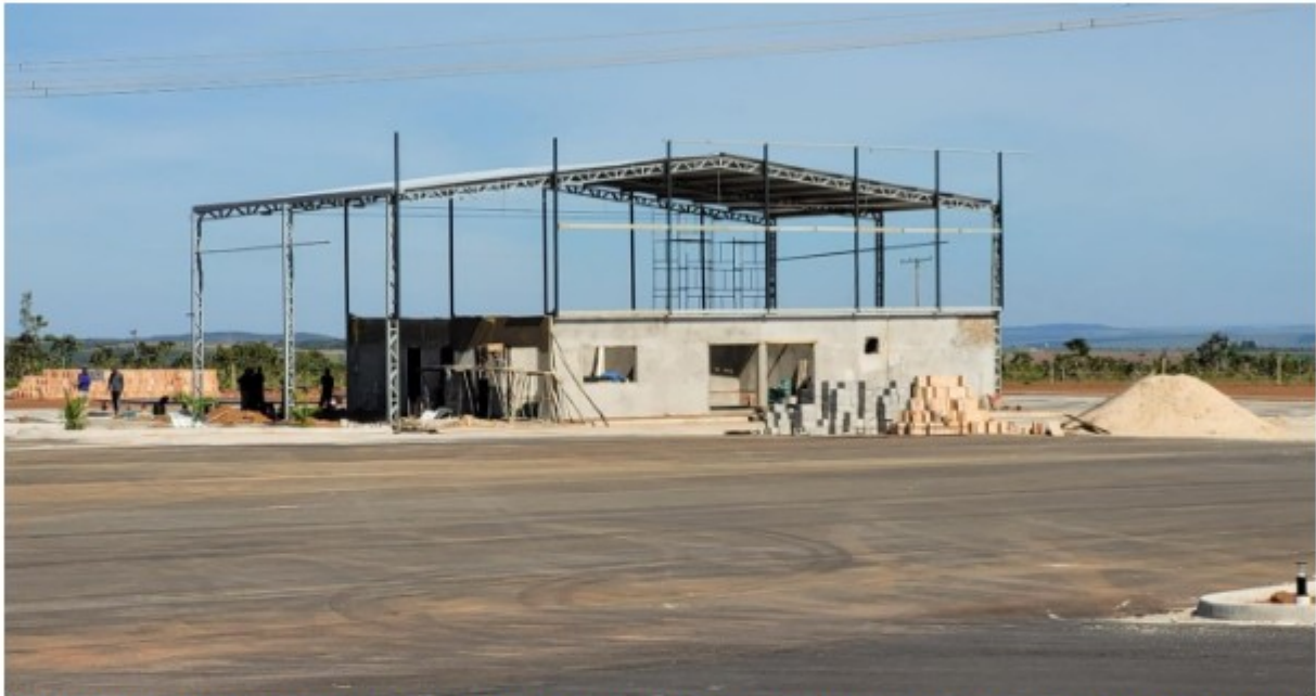
Foto 2. Vista do prédio em construção que abrigará os vestiários, borracharia e rampa de troca de óleo. Registro efetuado em 09/05/2023.
