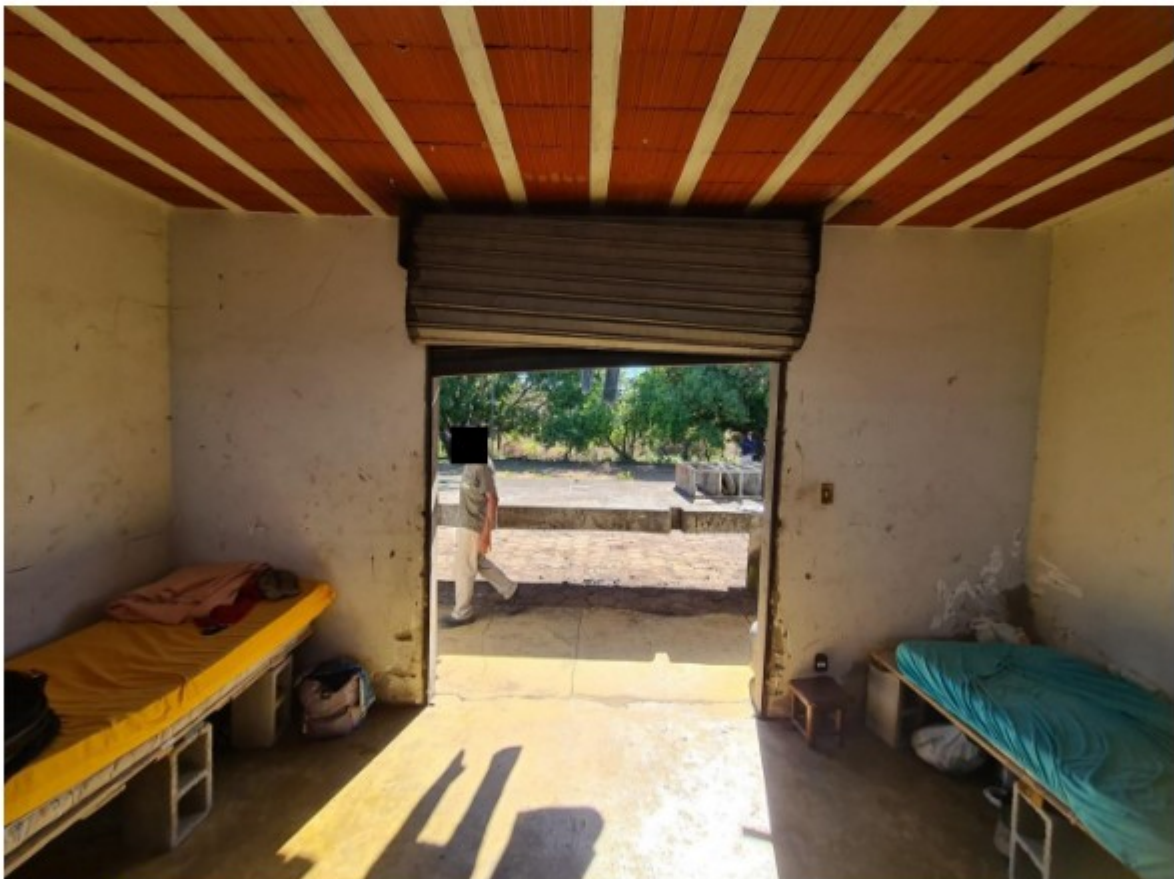
Foto 14. Vista do depósito utilizado como dormitório por seis trabalhadores. A porta de enrolar estava emperrada e não podia ser fechada. Registro efetuado em 09/05/2023.
