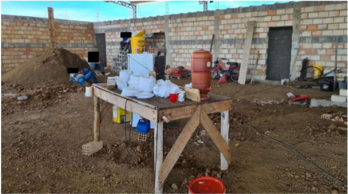
Foto 6. Vista do interior do prédio em construção que abrigará o restaurante. O local, que era usado pelos trabalhadores por ocasião do intervalo para repouso ou alimentação, possuía uma única mesa, que pode ser vista na foto. Registro efetuado em 09/05/2023.
