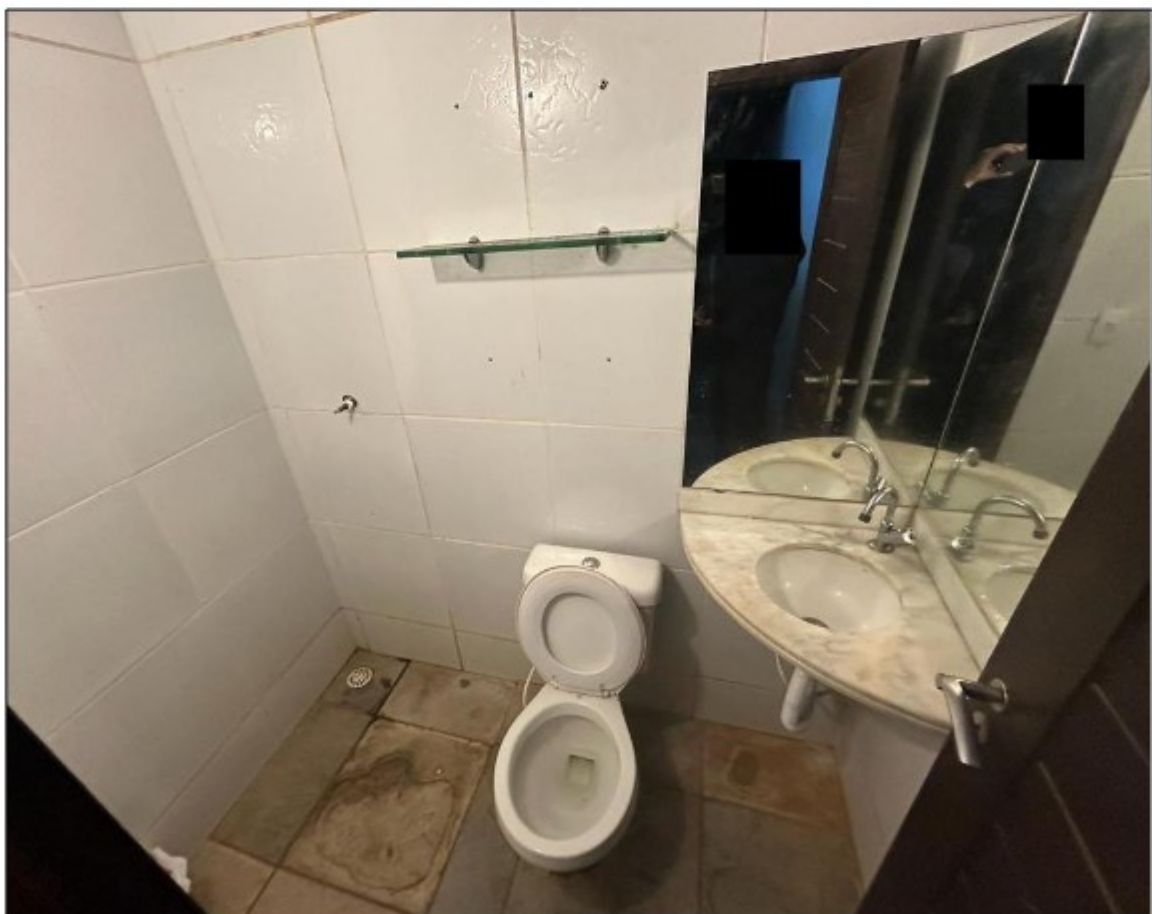
Imagem acima: A instalação sanitária que estava disponível aos trabalhadores do estabelecimento e ficava disposta anexa ao bar não estava provida de papel higiênico, bem como de material ou dispositivo para a limpeza, enxugo ou secagem das mãos
