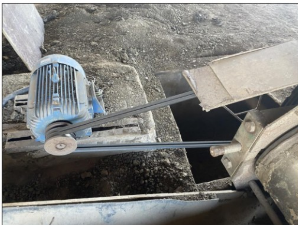
Foto acima: Transmissões de força do laminador de barro, sem qualquer proteção.
