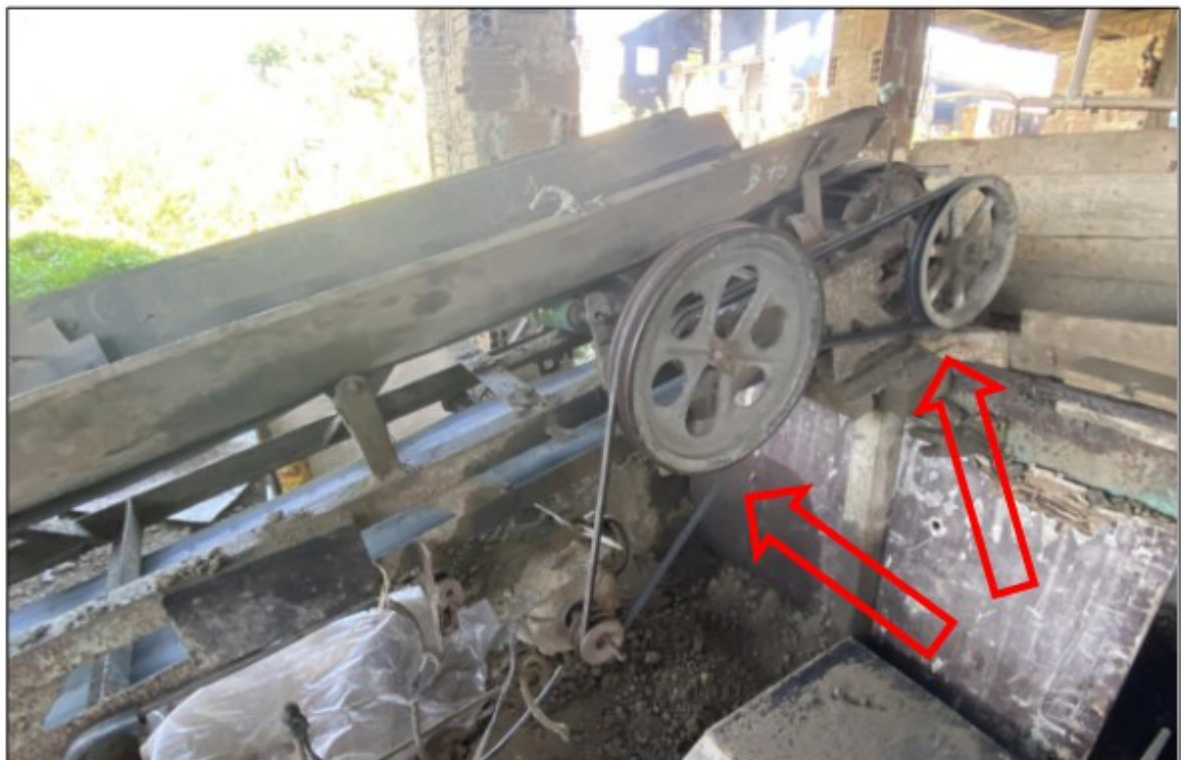
Foto acima: Transmissões de força do primeiro transportador contínuo, sem qualquer proteção.
