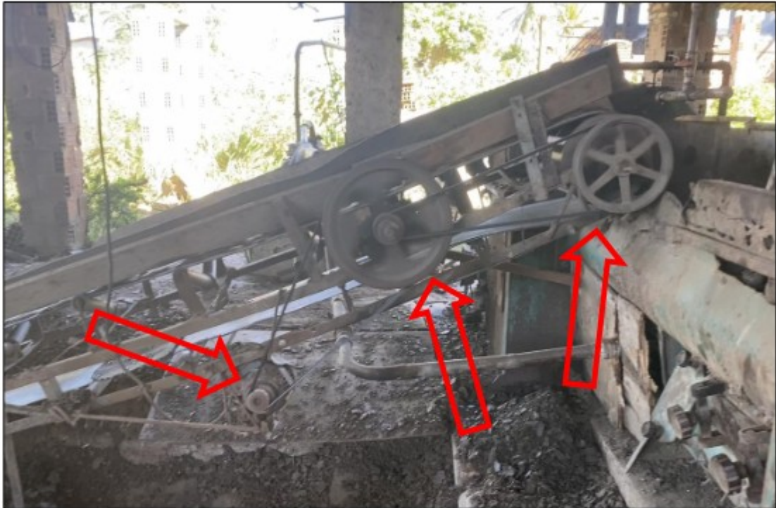
Foto acima: Transmissões de força do segundo transportador contínuo, sem qualquer proteção.
