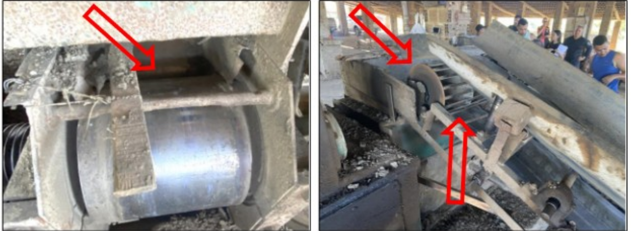
Fotos acima: Zonas de perigo do laminador de barro (à esquerda) e do segundo transportador contínuo (à direita) desprotegidas.
