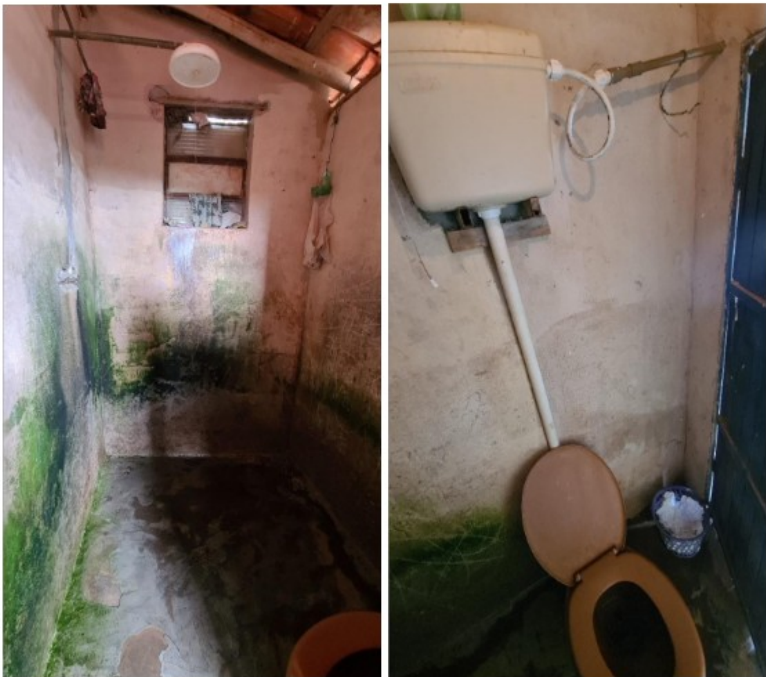
Fotos da instalação sanitária do alojamento
