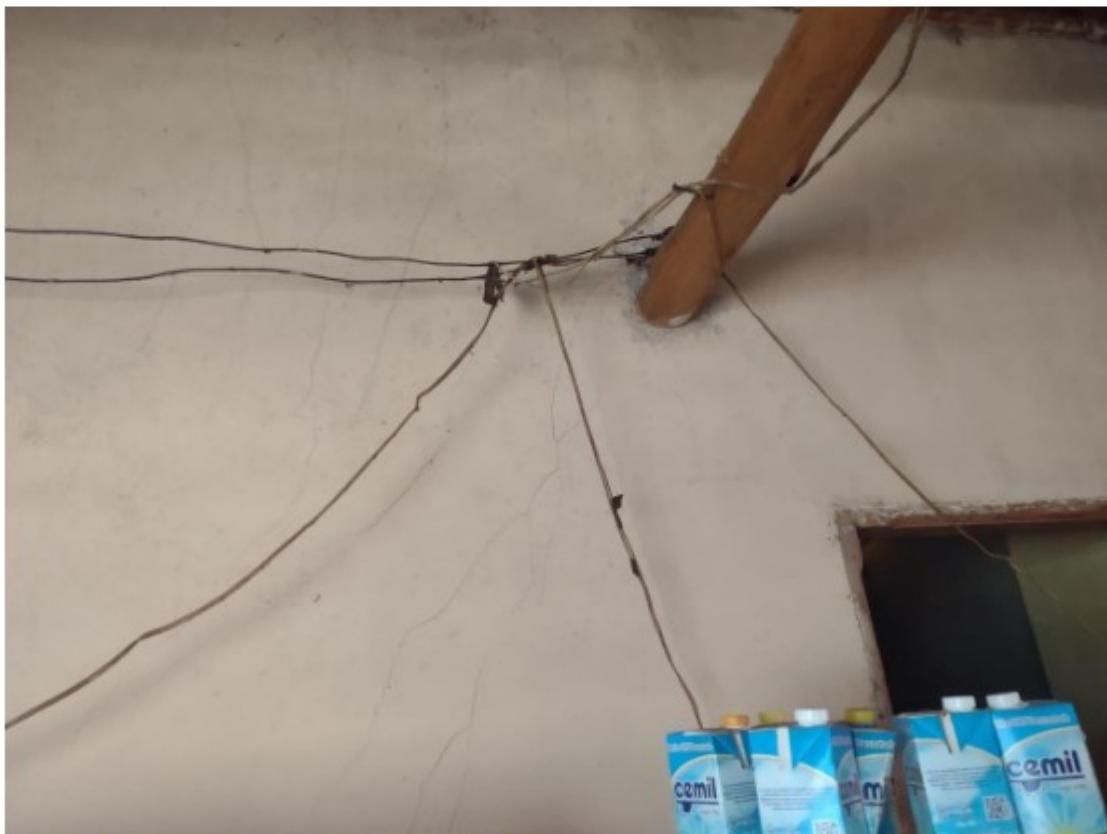
Fotos das instalações elétricas do alojamentos
