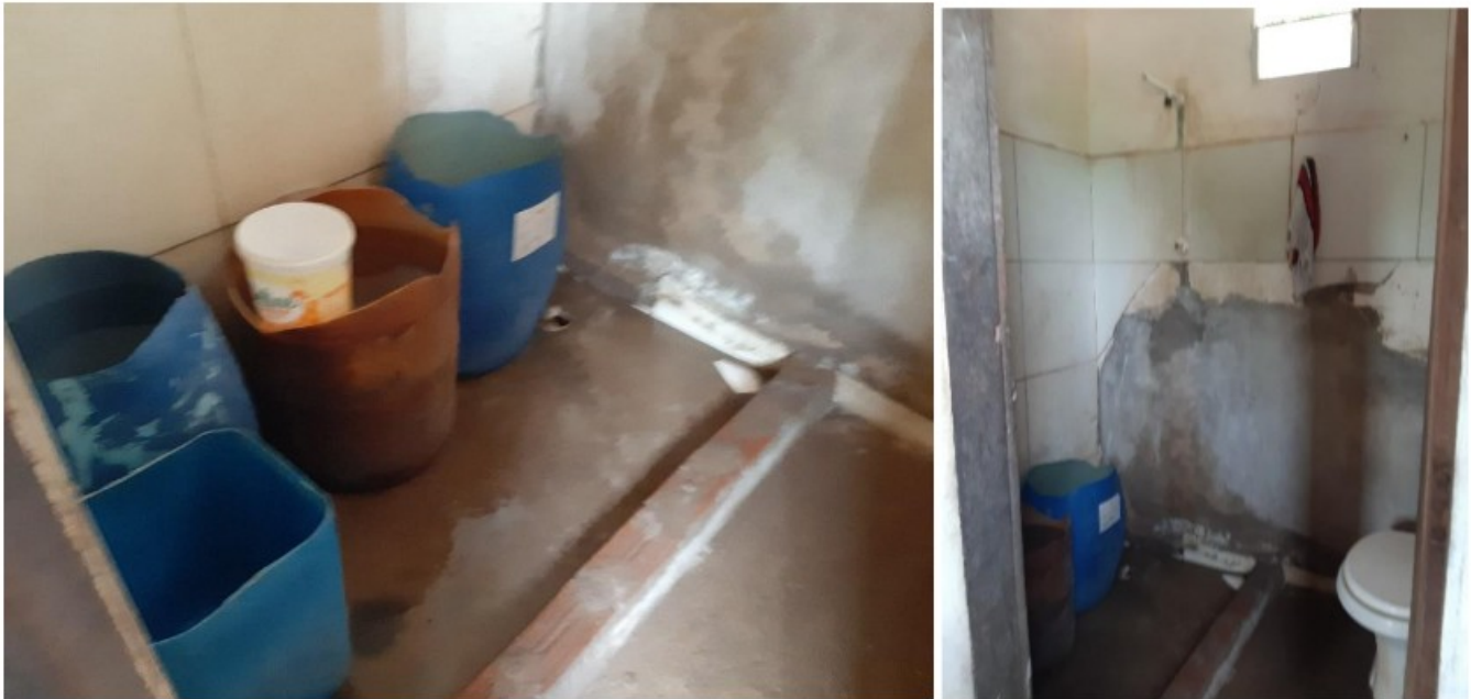
Fig.03 e 04: Banheiro disponibilizado pela empresa com piso sem revestimento.
