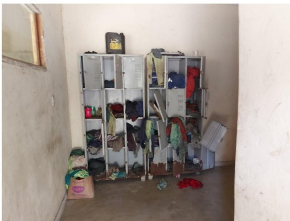
Fotos 7 e 8: interior das instalações sanitárias com box do chuveiro sem porta e armários danificados.
