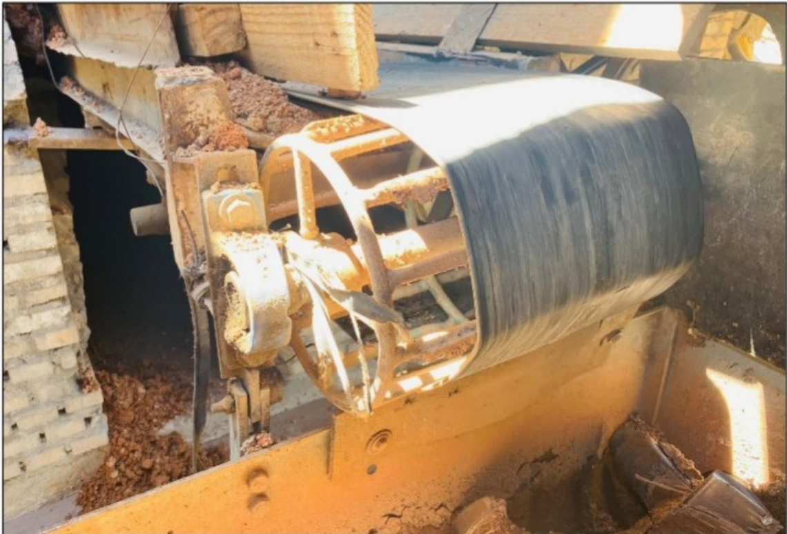
Imagem acima: Transportador contínuo de materiais sem proteção da zona de perigo.
