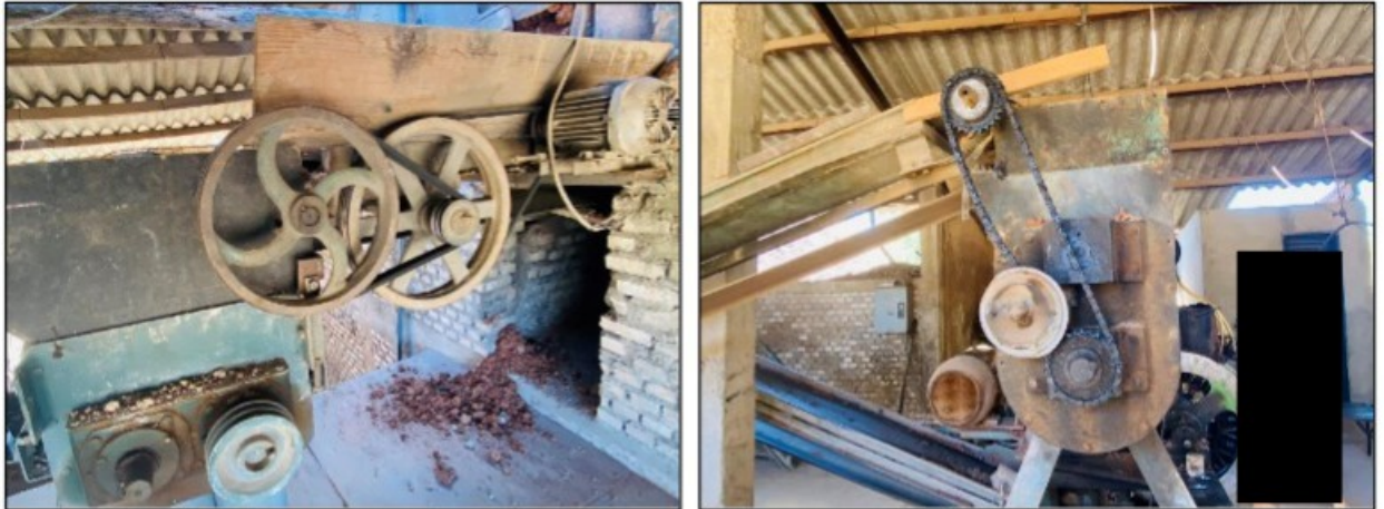
Imagem acima: Transmissões de força de máquinas sem qualquer proteção.
