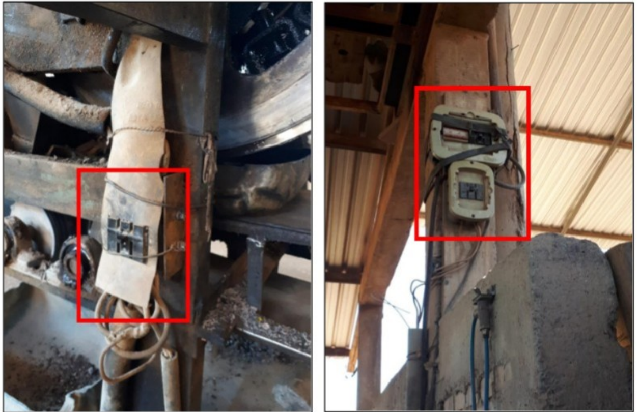
Imagem acima: As máquinas eram acionadas por meio de disjuntores.
