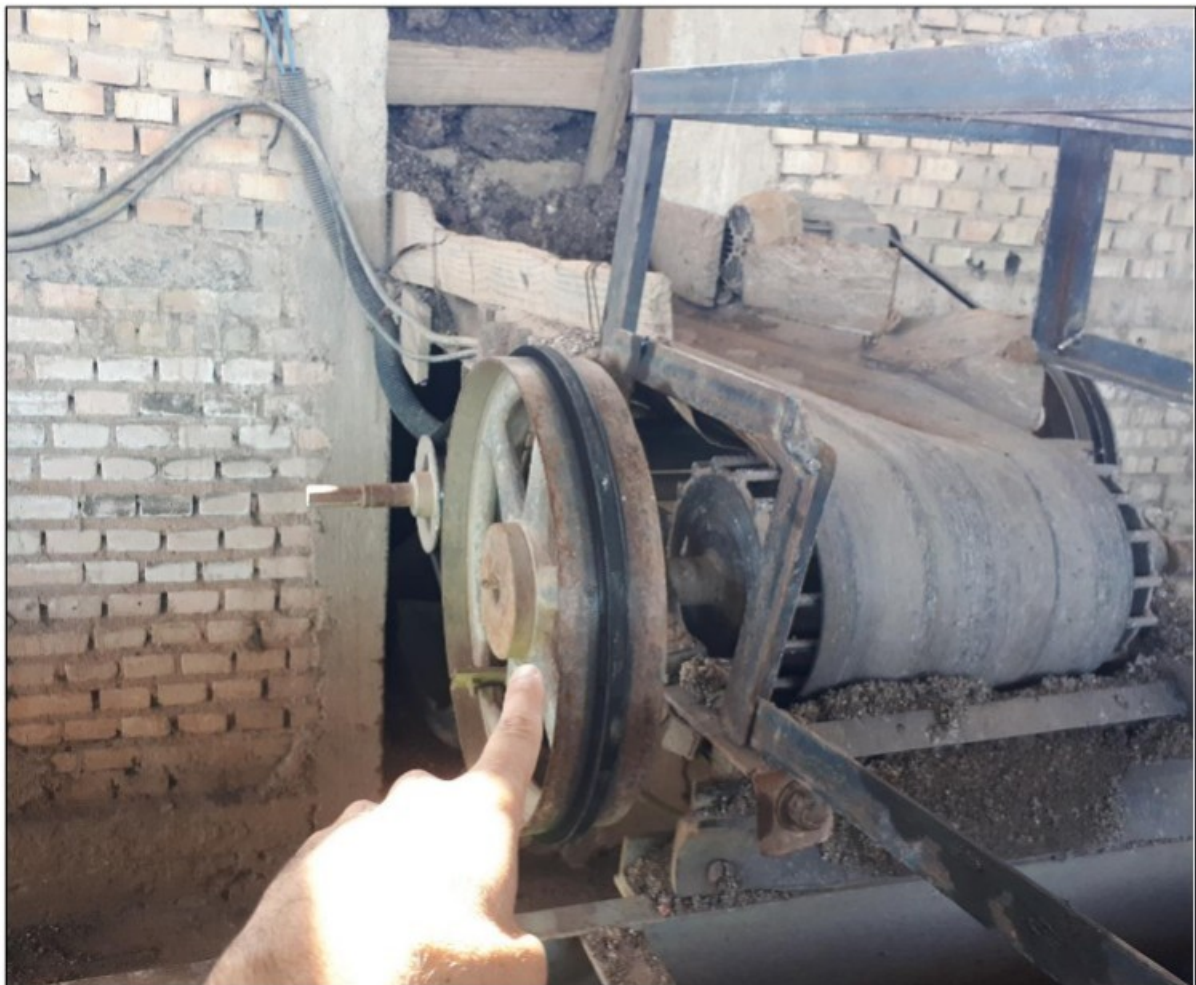
Imagem acima: Transportador contínuo de materiais sem proteção da zona de perigo.
