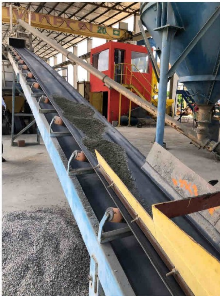
Figura 7 Transmissões de força da esteira transportadora sem proteção.
