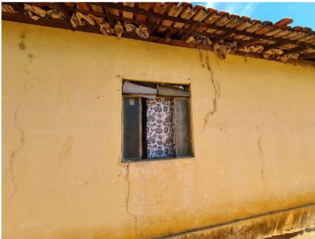
Imagem 10. Vista externa da janela do quarto utilizado pela família de [REDACTED]. Em substituição aos vidros quebrados da janela foram improvisados fechamentos com uso de tecidos e papelão, buscando dar um certo grau de vedação ao imóvel. Registro fotográfico efetuado em 24/10/2022.
