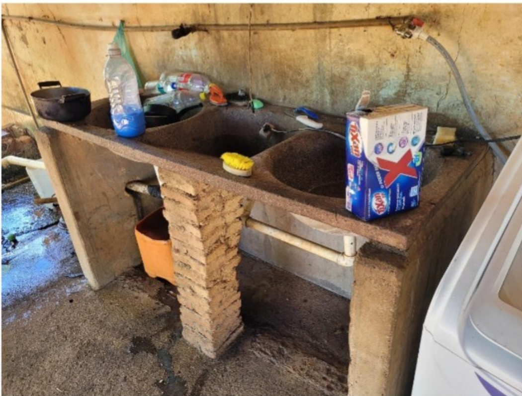
Imagem 15. Vista da lavanderia do existente na parte posterior do alojamento. Tomada improvisada em área úmida, com risco de choque elétrico. Registro fotográfico efetuado em 24/10/2022.
