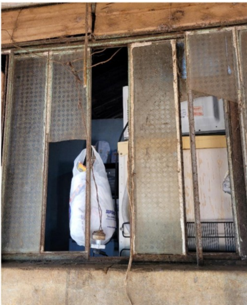
Imagem 11. Janela da cozinha, com vidros quebrados e improvisação da rede elétrica. Registro fotográfico efetuado em 24/10/2022.
