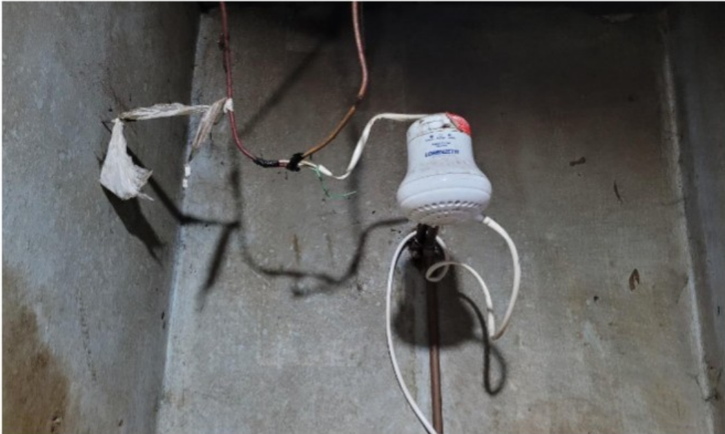
Imagem 12. Chuveiro com instalações elétricas precárias. Registro fotográfico efetuado em 24/10/2022.
