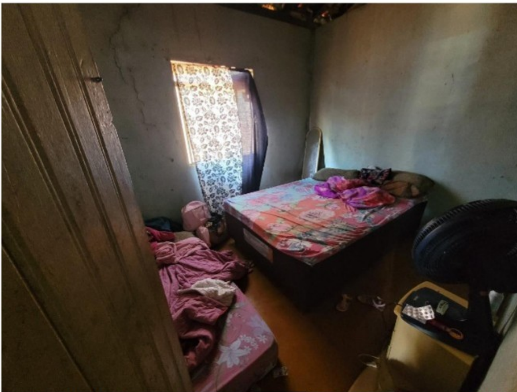
Imagem 9. Quarto utilizado pela família de [REDACTED]. Em substituição aos vidros quebrados da janela foram improvisados fechamentos com uso de tecidos e papelão, buscando dar um certo grau de vedação ao imóvel. Móveis e utensílios como cama e criado pertenciam à família de [REDACTED] e somente chegaram ao imóvel em 22/02/2022. Registro fotográfico efetuado em 24/10/2022.
