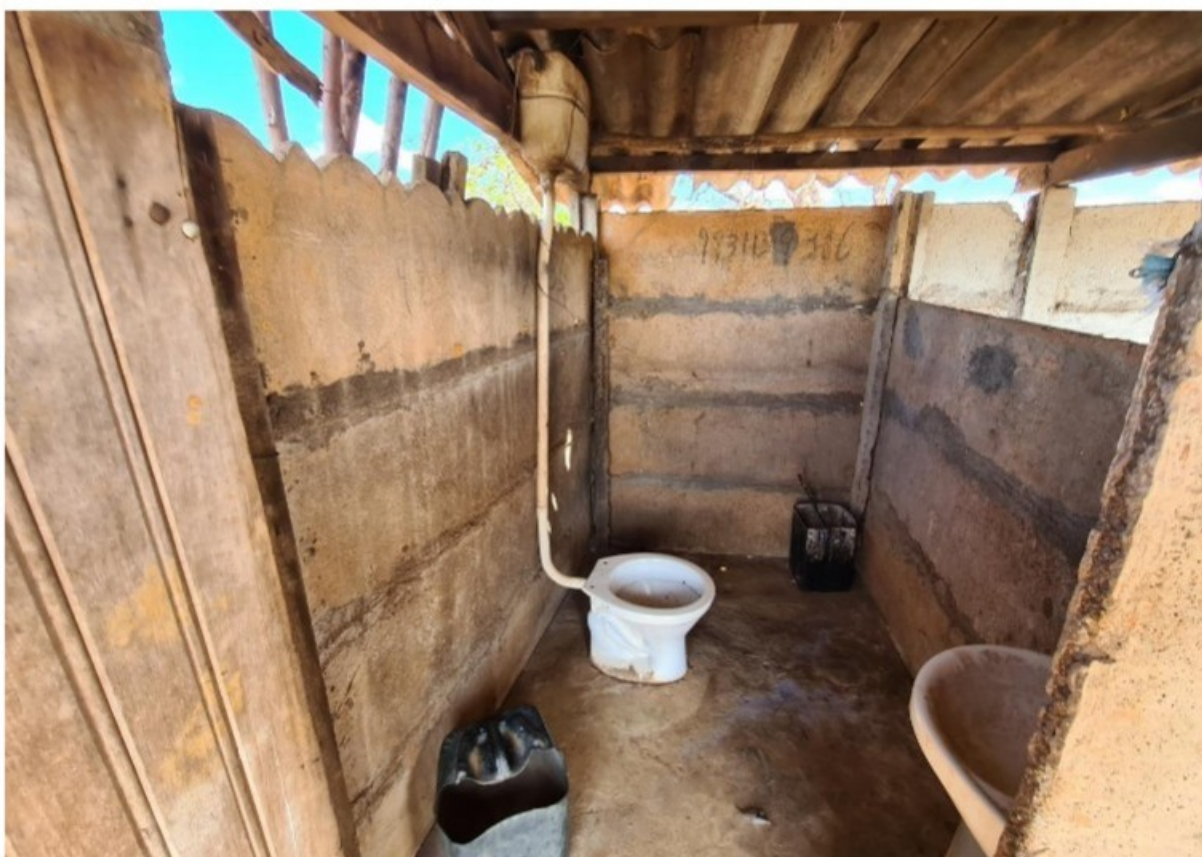
Imagem 7. Instalação sanitária da frente de trabalho. Os equipamentos sanitários não eram servidos de água, inviabilizando o seu uso de forma higiênica. Registro fotográfico efetuado em 24/10/2022.
