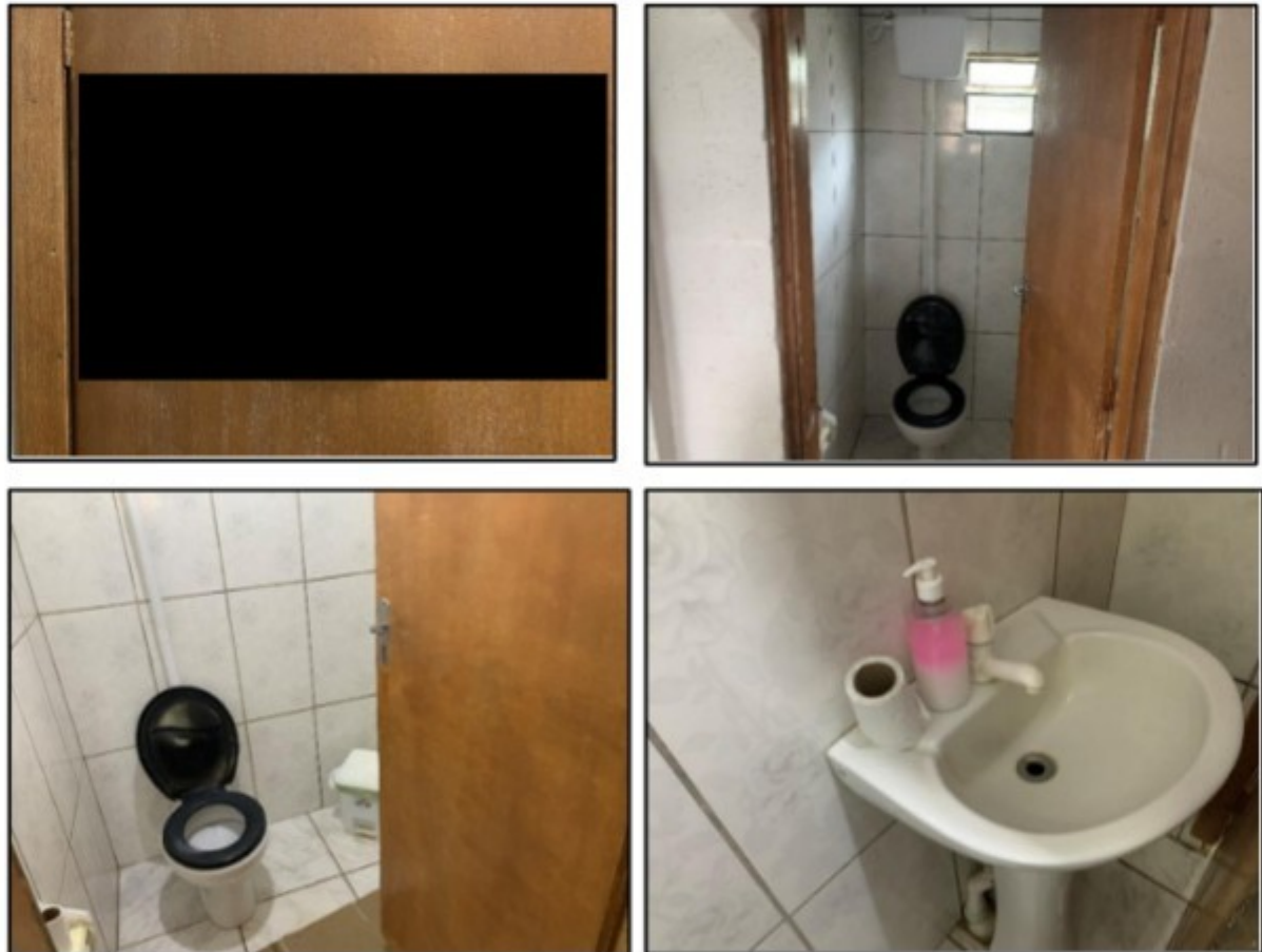
Figura 7 – Único banheiro existente no estabelecimento
