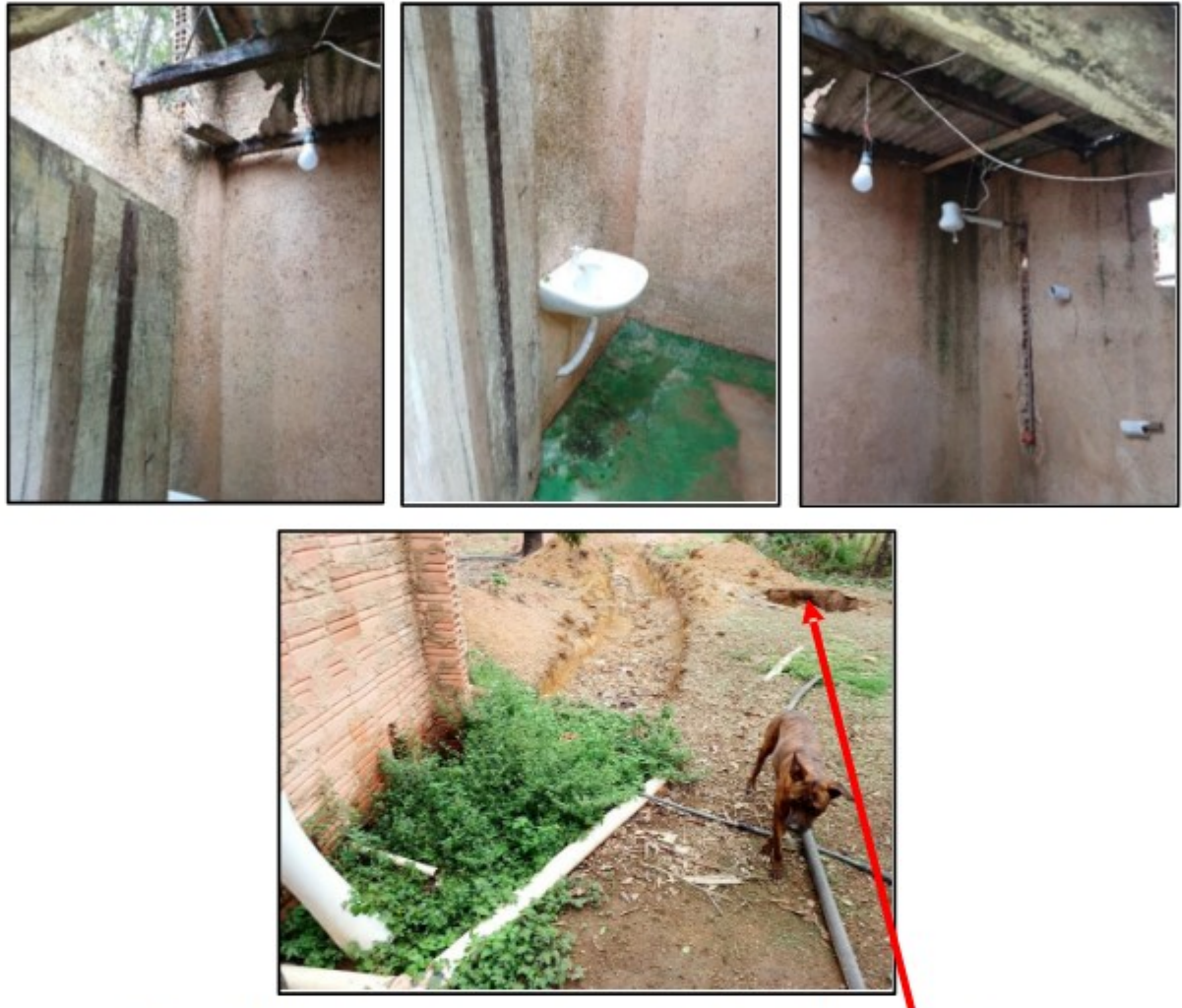
Figura 4 - Instalação sanitária externa, cobertura quebrada, e saída do esgoto a céu aberto.
