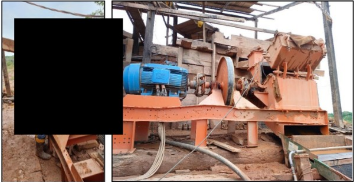
Figura 10 - Máquinas montadas sem a supervisão de profissional habilitado
