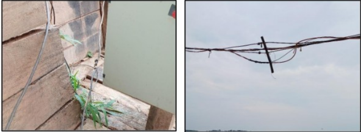
Figura 9 - Instalações elétricas precárias
