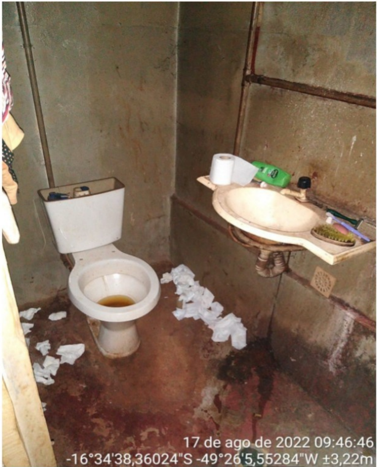
Instalação sanitária no cômodo do senhor [REDACTED]
