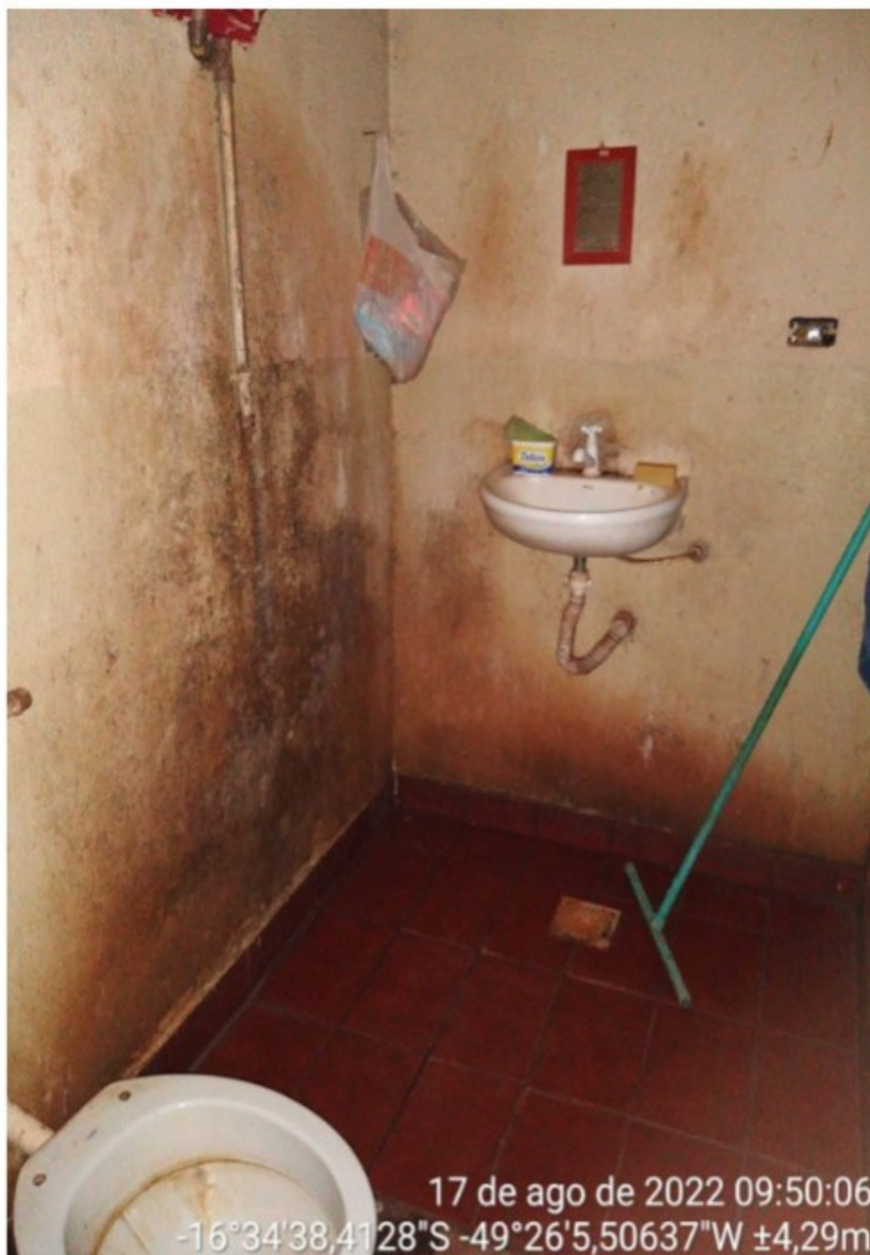
Instalação sanitária no cômodo do senhor [REDACTED]
