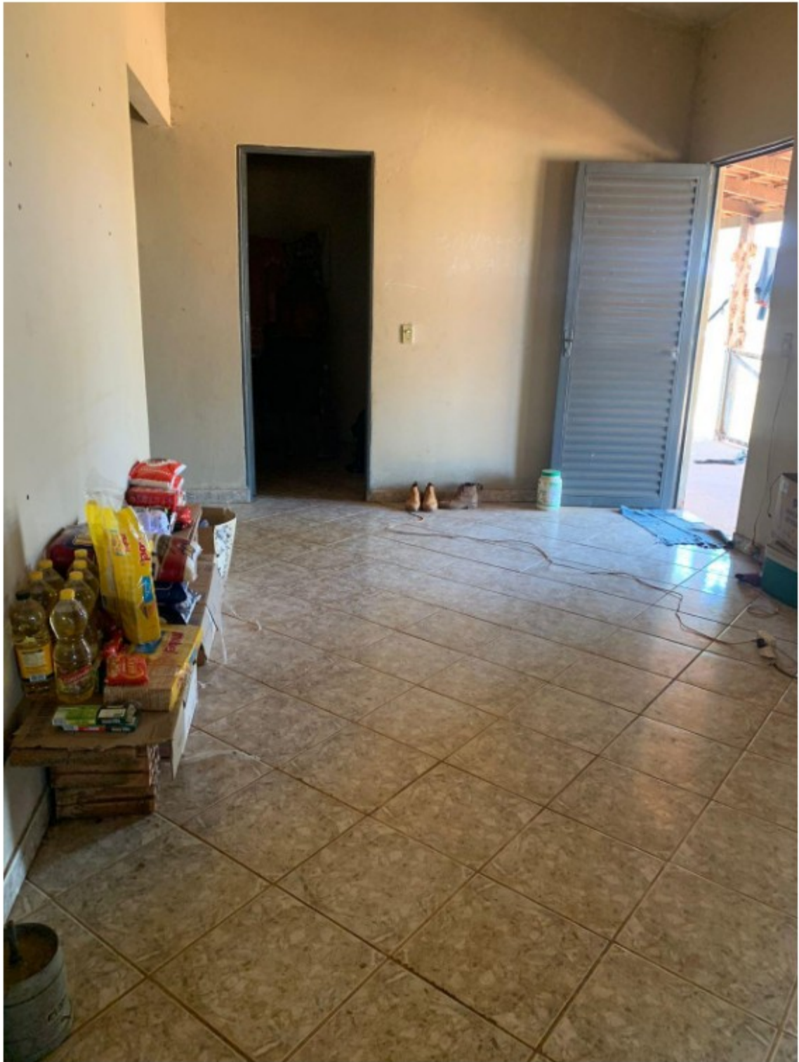
Condições do piso e paredes de um dos alojamentos utilizados pelos empregados
