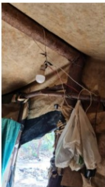
FOTO 37 – Interior do local de moradia – detalhe para a lâmpada e a fiação elétrica.
