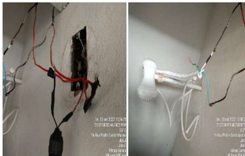
Fotos: Instalações elétricas com risco de choque elétrico e outros acidentes.
