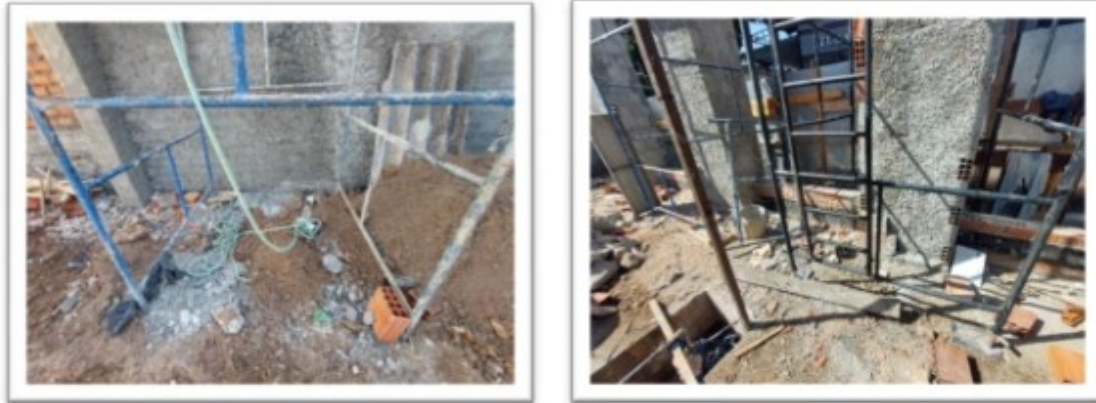
Figura 9 - Escadas sem proteção contra queda.
