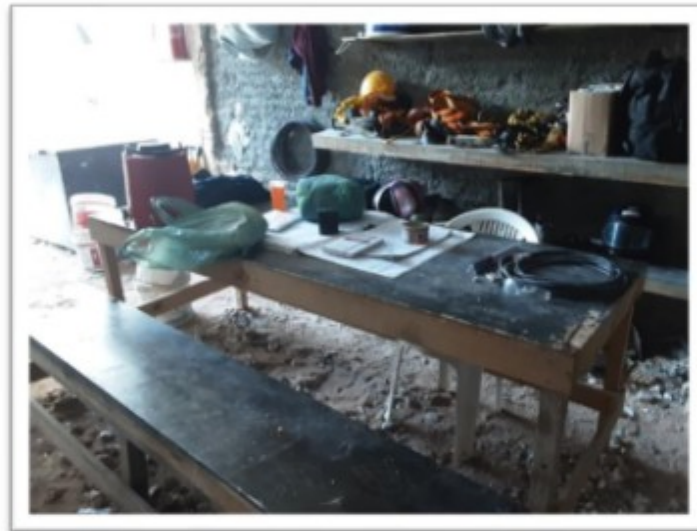
Figura 8 - Local de tomada de refeições subdimensionados para 23 trabalhadores e sem condições de higiene e conforto. Os demais trabalhadores tomavam as refeições de forma improvisada no canteiro de obras. A mesa de tomada de refeições também era utilizada para finalidades diversas.
