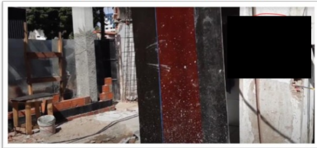
Figura 3 - Instalação sanitária subdimensionada para 23 trabalhadores e sem condições de higiene em razão de estar em ambiente de trabalho desorganizado e sujo do canteiro de obras. O cozinheiro não possuía instalação sanitária exclusiva para evitar a contaminação cruzada, portanto, utilizava o mesmo banheiros dos demais trabalhadores.
