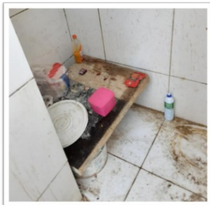
Figura 7 - Local de preparo das refeições ao lado da instalação sanitária de uso dos trabalhadores em geral.
