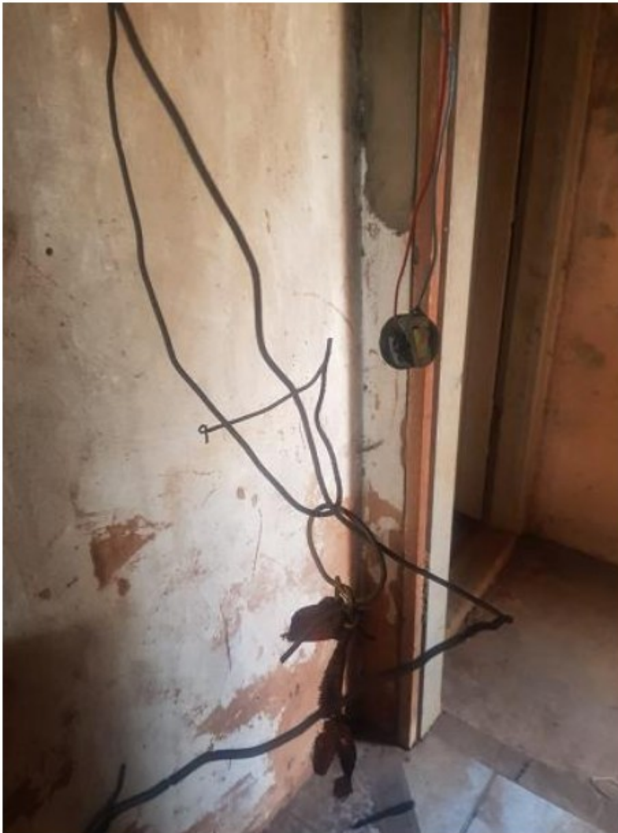
Improvisação das instalações elétricas
