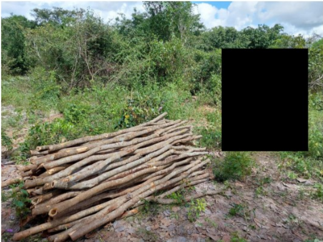
Figura 4 Trabalhador laborando no corte de madeira sem qualquer EPI - Equipamento de Proteção Individual.
