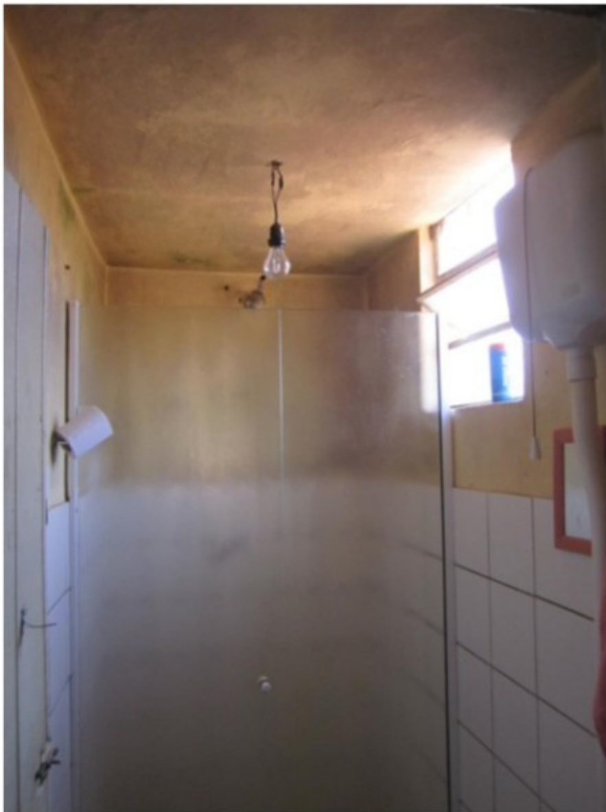
(foto: instalação sanitária sem chuveiro e compartilhada entre homens e mulheres alojados)
