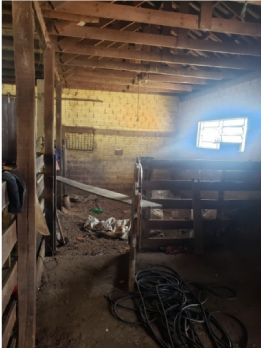
Ao fundo da foto, área interna ao lado da área de preparo de alimentos para os trabalhadores indígenas resgatados, sem piso de alvenaria: um exemplo de que o que pode parecer natural para os empregados indígenas não é aceitável à luz da legislação trabalhista brasileira
