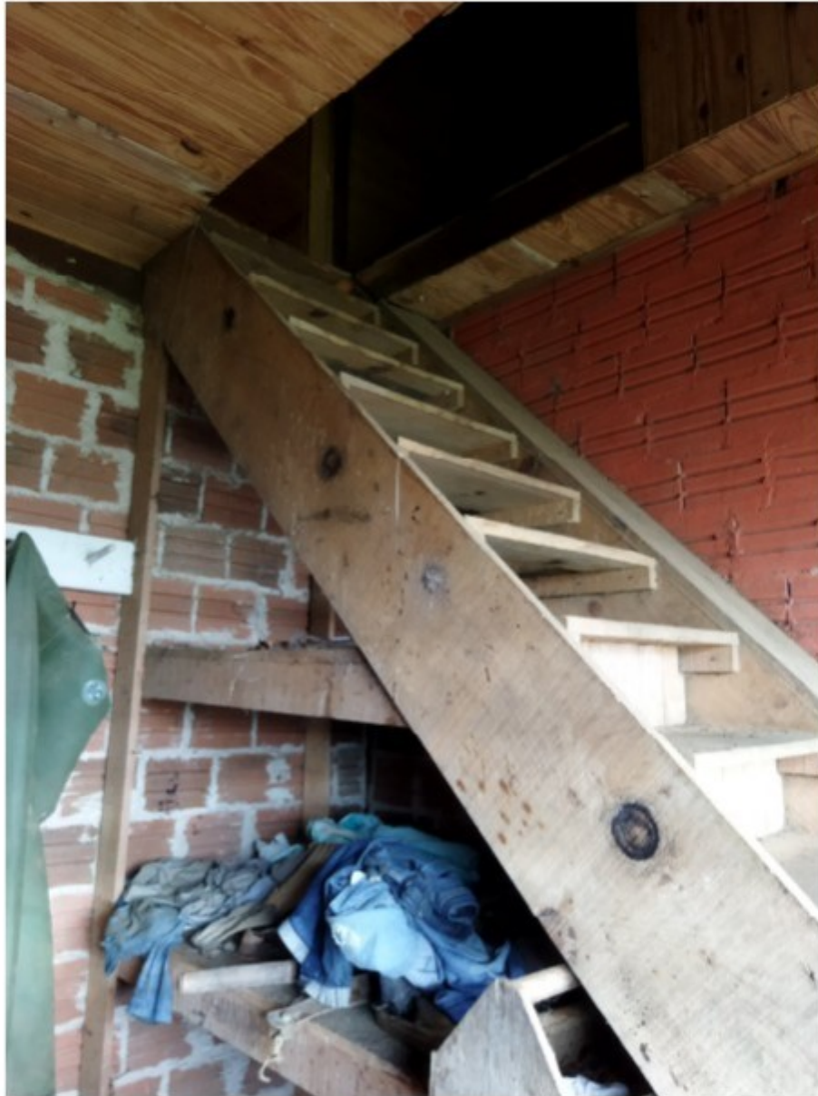
Foto da escada interna do alojamento, sem corrimão e rodapé, encontrada pelo Comando de Inspeção em 06 de abril de 2022
