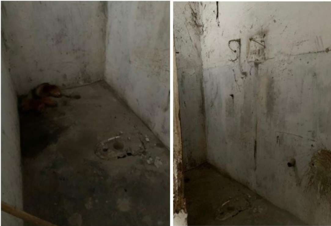
Imagens: Cômodo destinado a ser banheiro, demonstrando a inexistência de instalações sanitárias.
