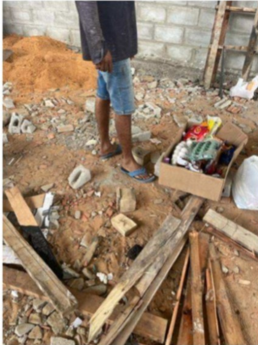
Trabalhadores laboram sem botas, luvas, óculos, capacetes e vestimentas de trabalho.
