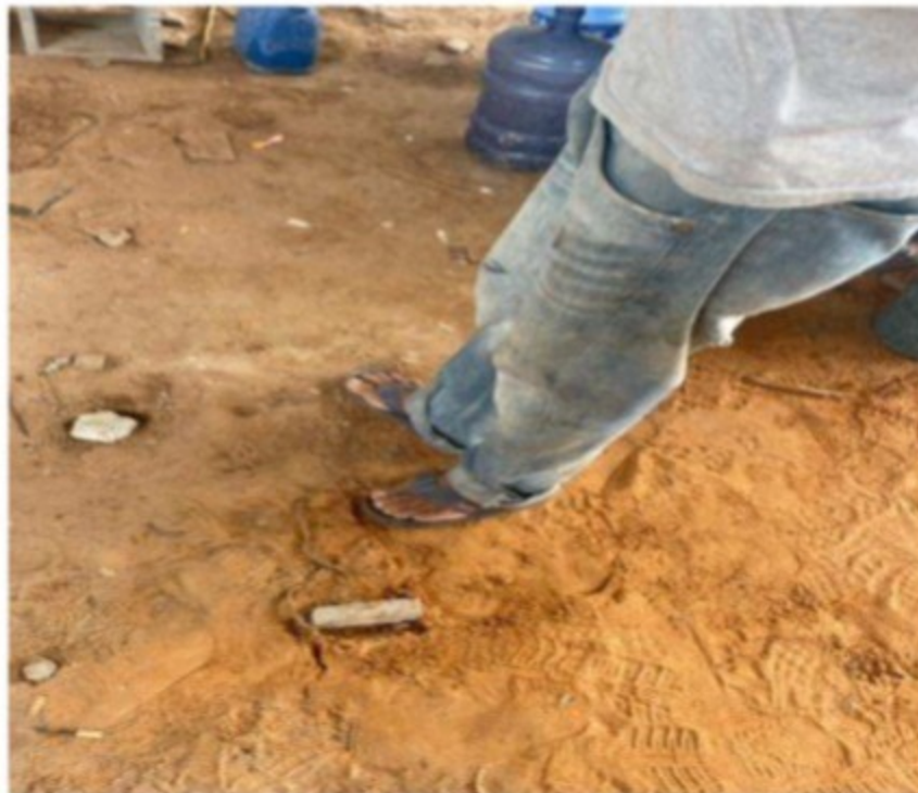
Trabalhadores laboram sem botas, luvas, óculos, capacetes e vestimentas de trabalho.
