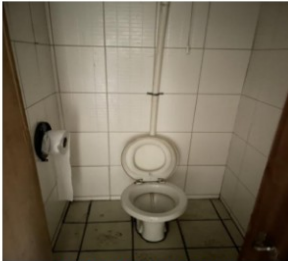
Foto 5: Banheiro sem iluminação.
