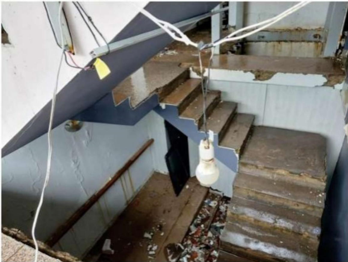
Figura 2 Ausência de proteção contra quedas
