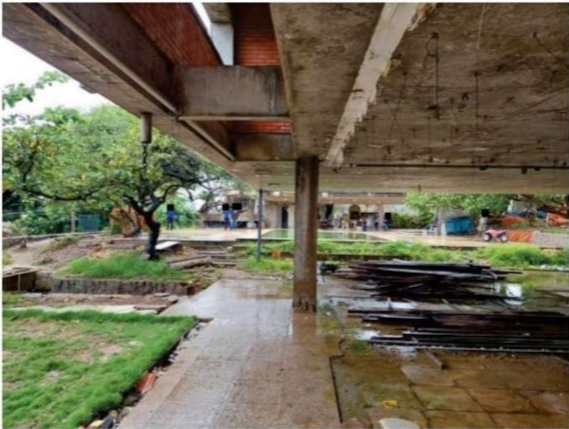
Figura 3 Piso com diversas aberturas sem proteção.
