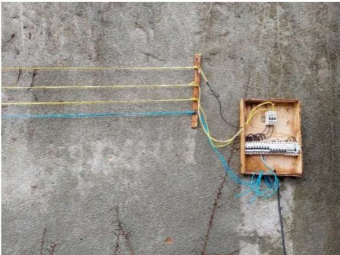
Figura 4 Quadro de distribuição elétrica sem tampa e sem identificação dos circuitos.
