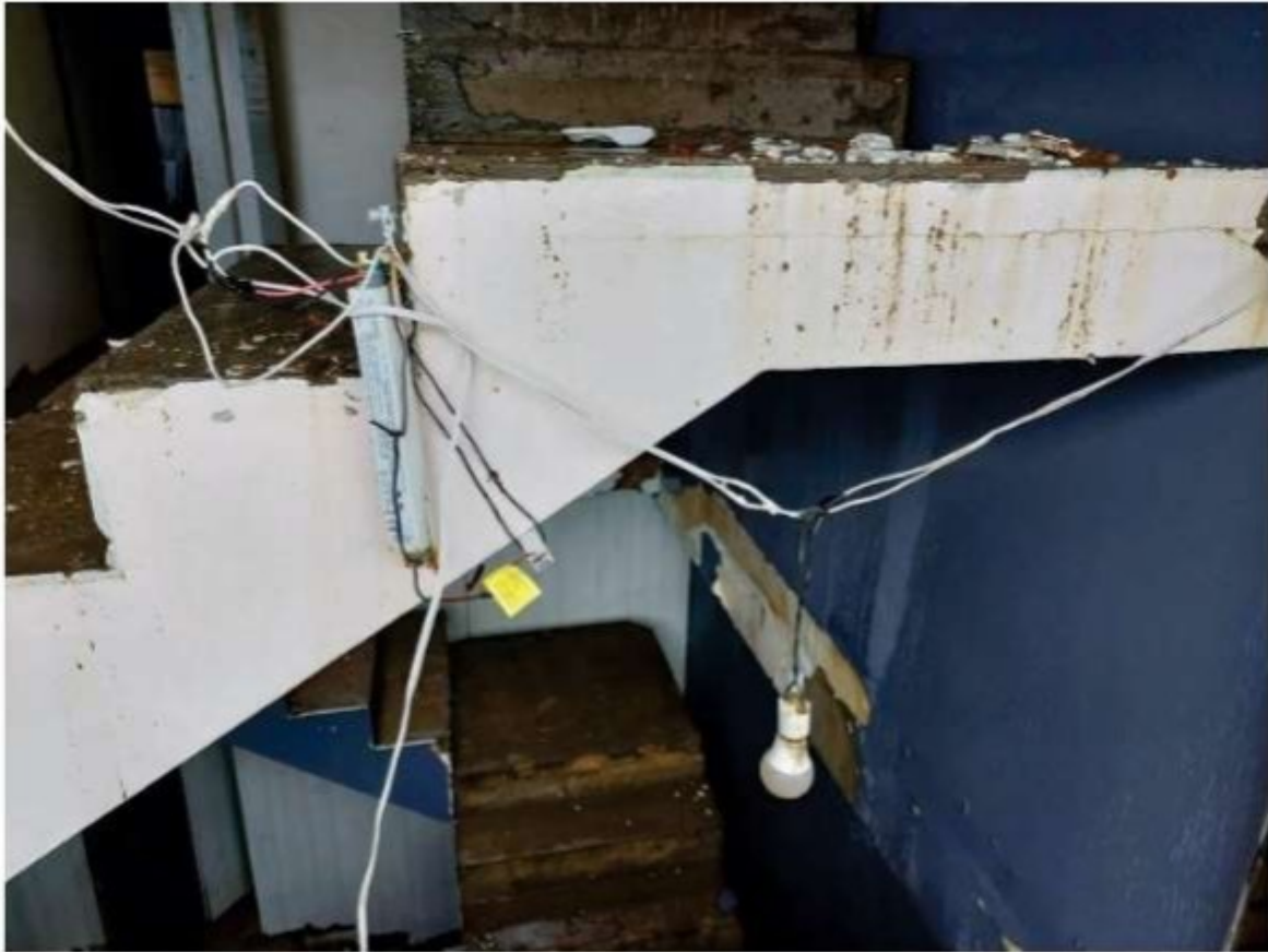
Figura 5 Fiação elétrica com partes vivas expostas.
