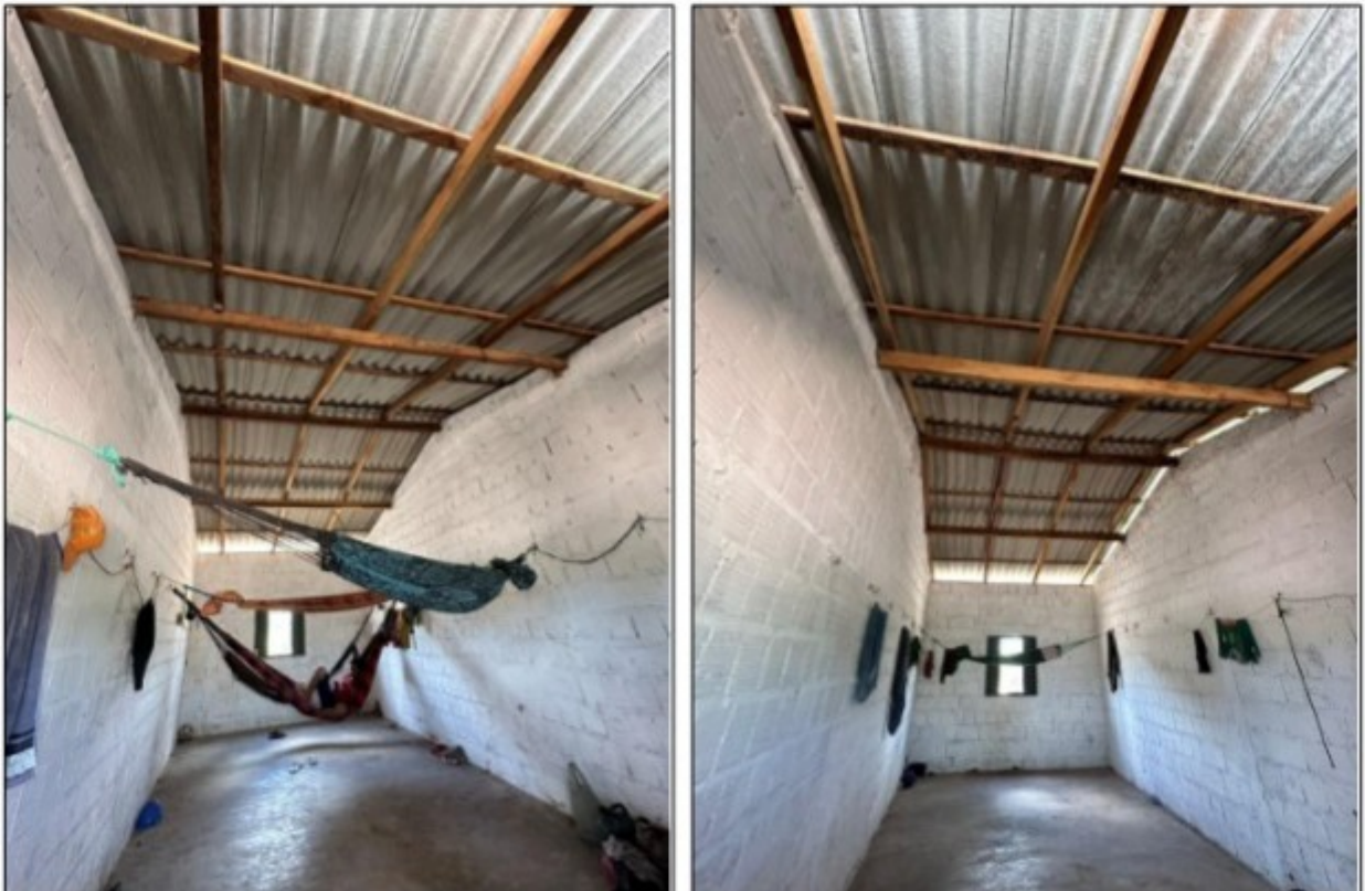
Fotos: Interior de dois dos dormitórios coletivos, nos quais não havia lâmpadas para iluminação à noite.
