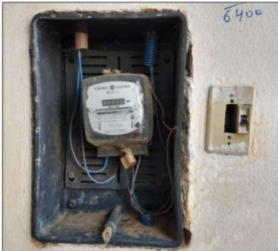
Imagem: O quadro de distribuição de energia da lavanderia não continha tampa e apresentava fios expostos e até desencapados.
