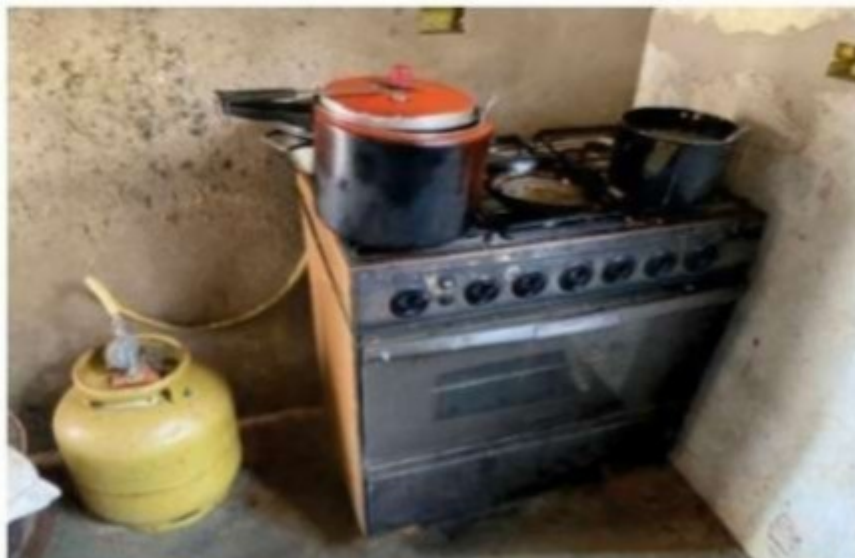
Figura 7: recipiente de GLP instalado dentro da cozinha.
