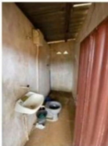
Foto 15 : Instalações sanitárias não havia água no banheiro e os trabalhadores afirmaram que faziam suas necessidades no mato
