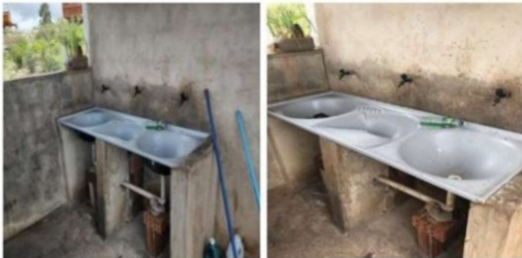
Fotos 24 e 25: Lavandreira
