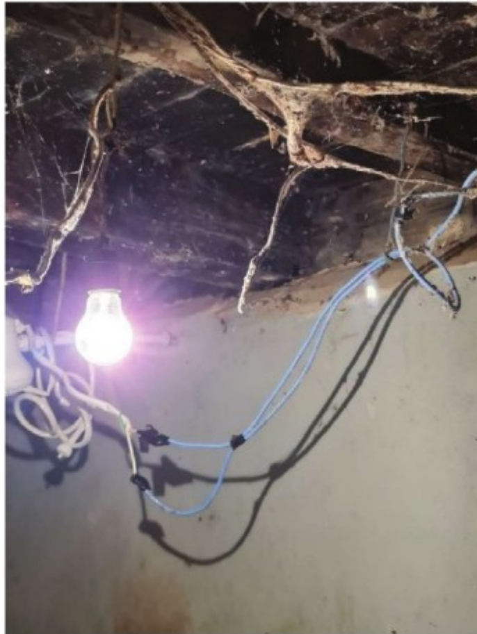
Instalações elétricas inadequadas em um dos alojamentos.
