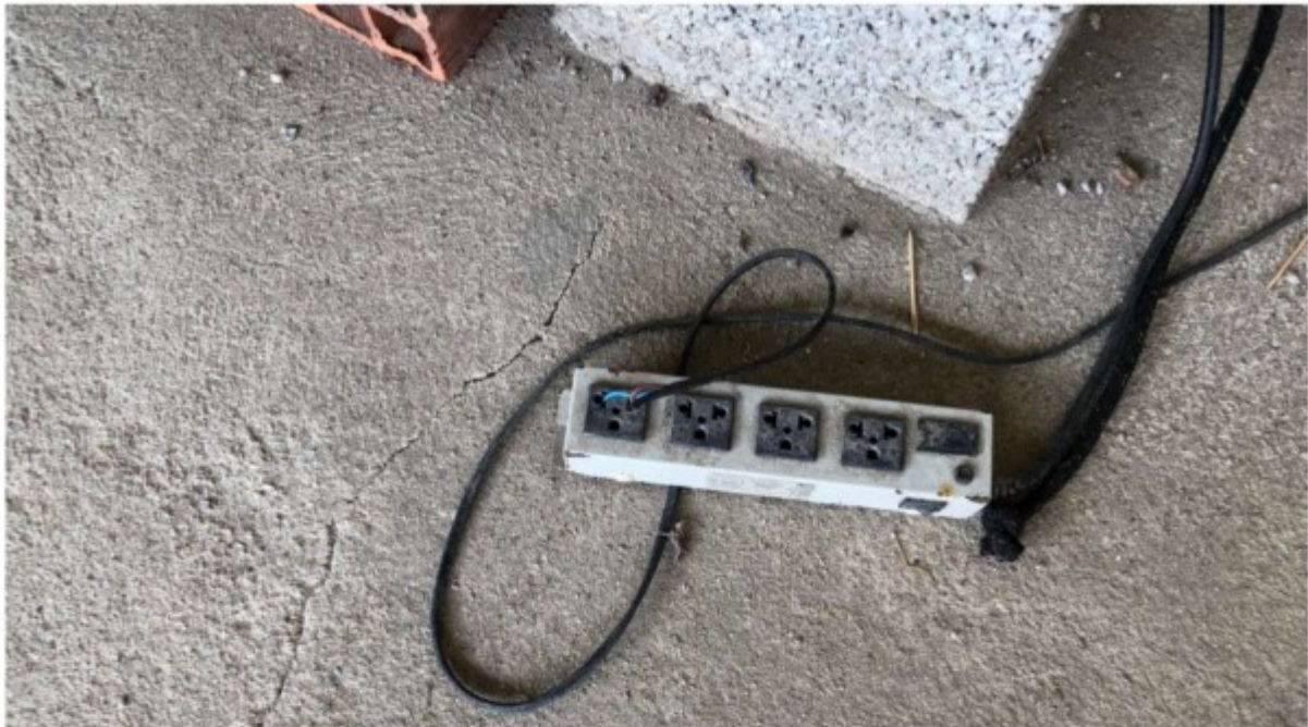
Figura 25 a 29: Situações com risco de choque elétrico no alojamento.
