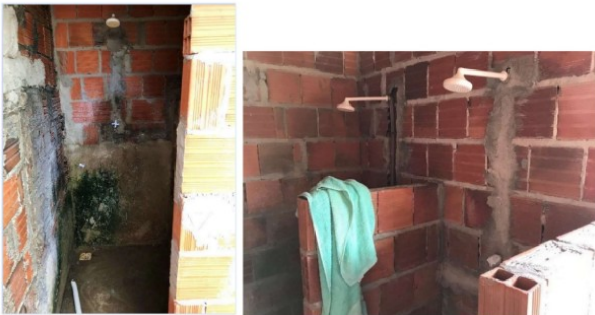
Figura 21 a 23: Instalações sanitárias sem portas, paredes sem reboco e sem papel higiênico.
