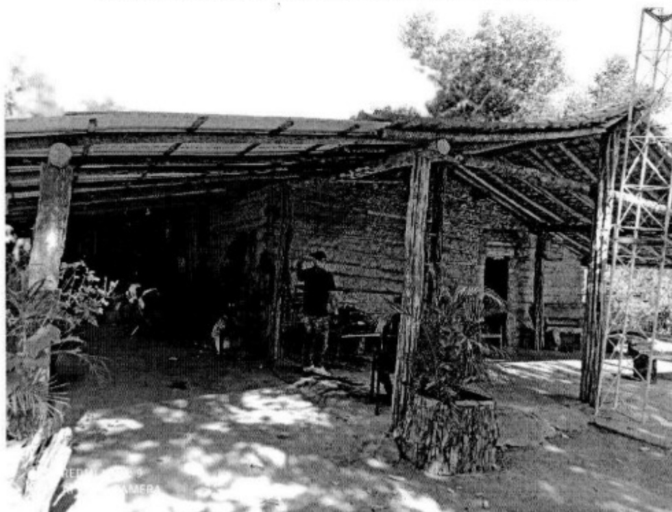
Moradia do empregador, usada como "área de vivência" pelos trabalhadores, desprovida de instalações sanitárias.
