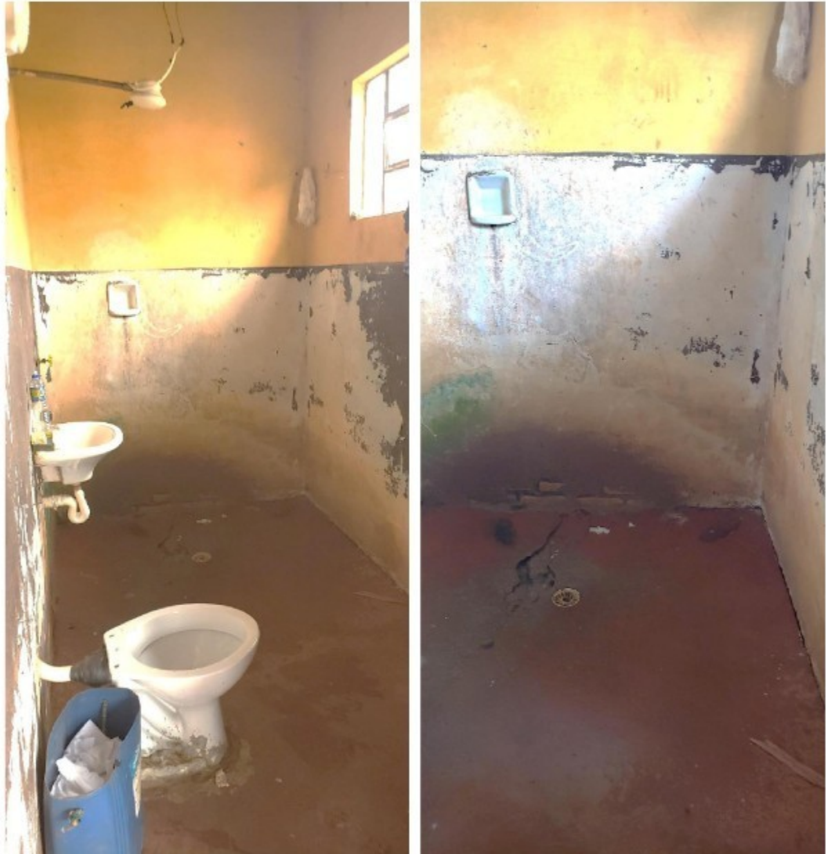
Imagens 13 e 14 – Instalação sanitária disponibilizadas aos resgatados na Fazenda Campo Novo (gleba arrendada pela Família [REDACTED] - zona rural de Aporé-GO), com piso quebrado e sem condições adequadas de limpeza e higiene.
