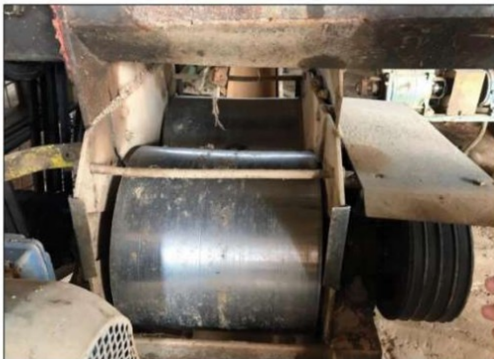
Imagem: Cilindro com zona perigosa não dotada de proteção.
