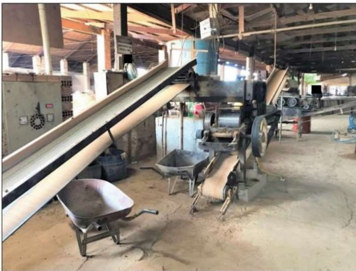
Imagem: Transportadores contínuos sem proteção das zonas perigosas.
