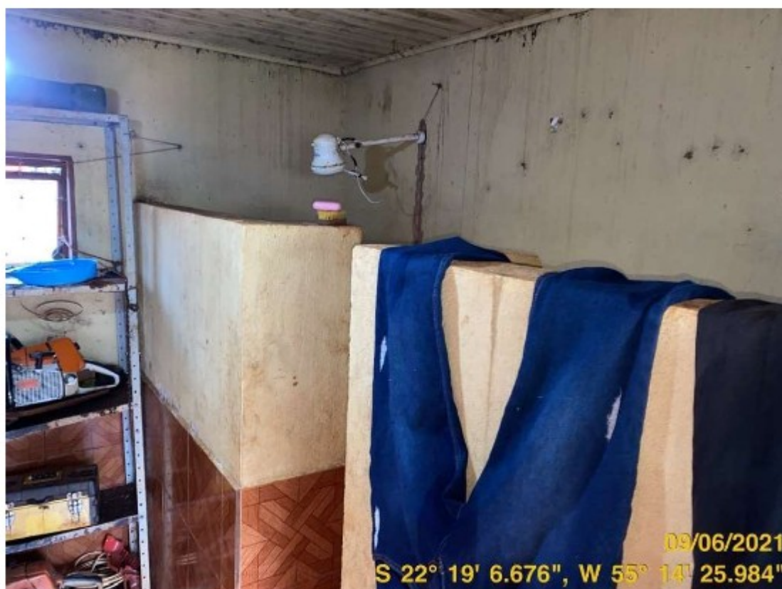
Foto 12: Chuveiro Existente – Sem Condições de Utilização
