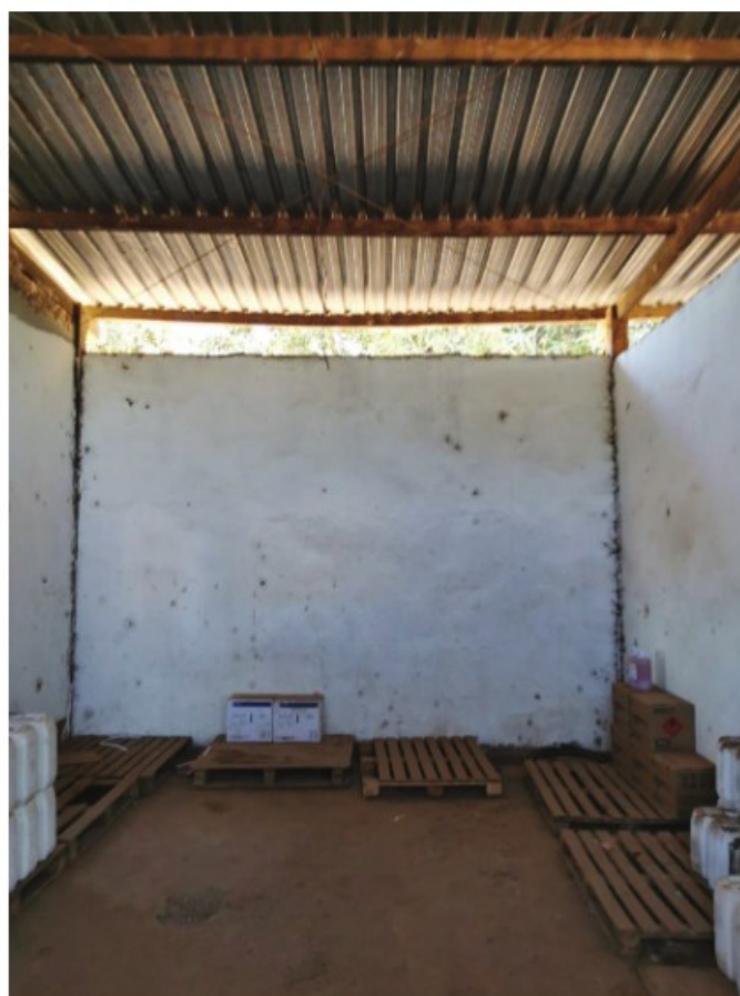
Depósito de agrotóxicos com aberturas sem proteção (telas) nas paredes, permitindo a entrada de animais.
