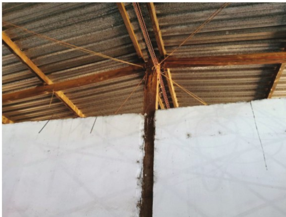
Abertura no teto do depósito, se comunicando com a oficina da fazenda.
