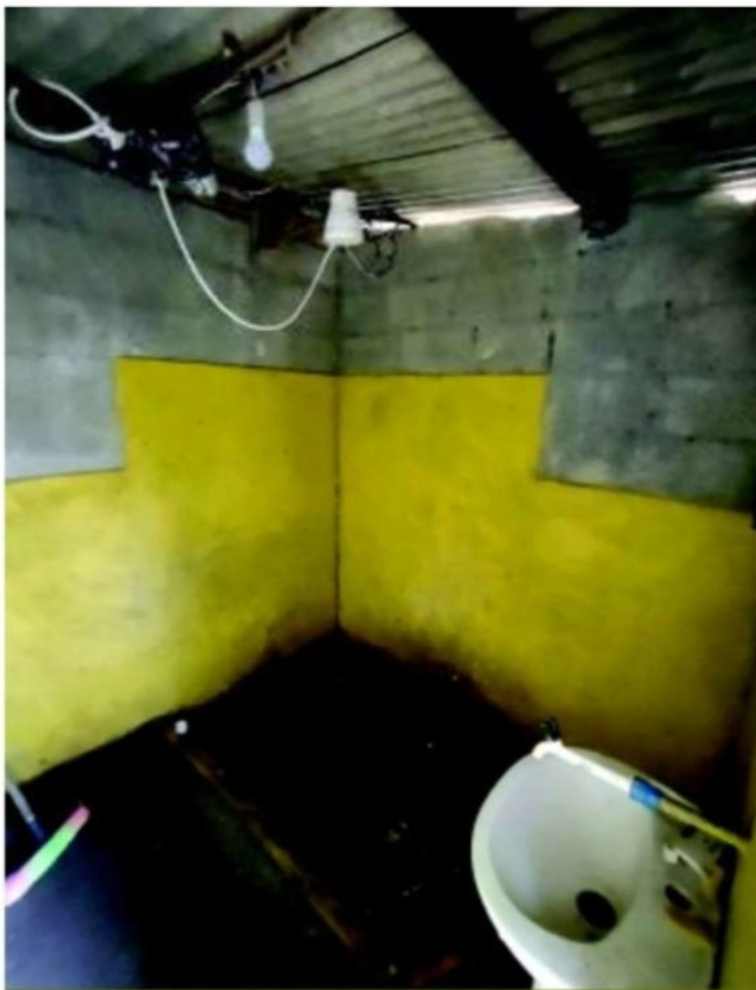
Fotos 6 e 7: Instalações elétricas com risco de choques no alojamento.
